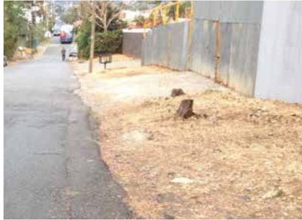
Figura 17. Ausencia de aceras, brocales y drenaje, Av 81 Fuente. Ortega y Valente (2017)
