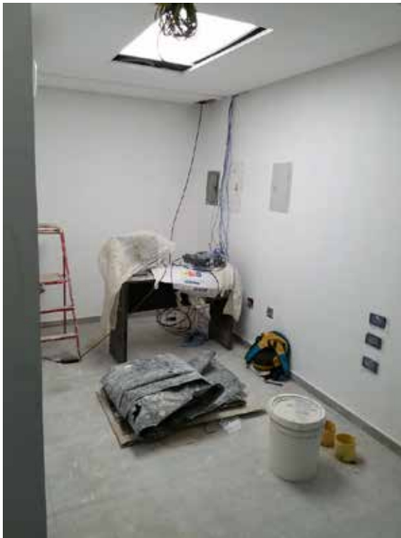
Figura 11. Otra vista de cuarto de comunicaciones de la radio.
