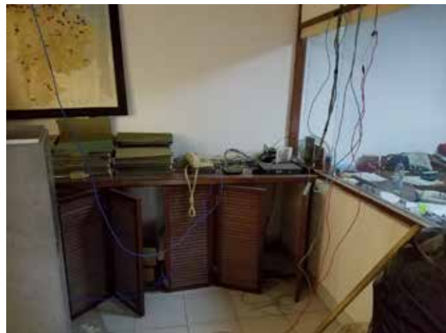
Figura 12. Cuarto actual de comunicaciones
