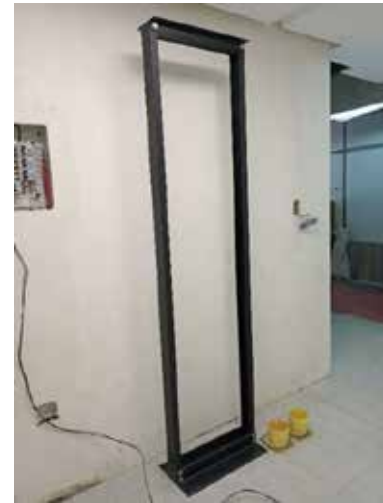
Figura 10. Rack de Comunicaciones donde se instalará Servidor VPN
