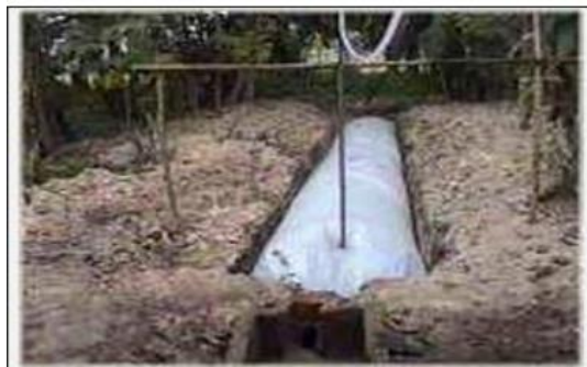
Figura 20: Biodigestor horizontal Fuente: Potón,(2019).
