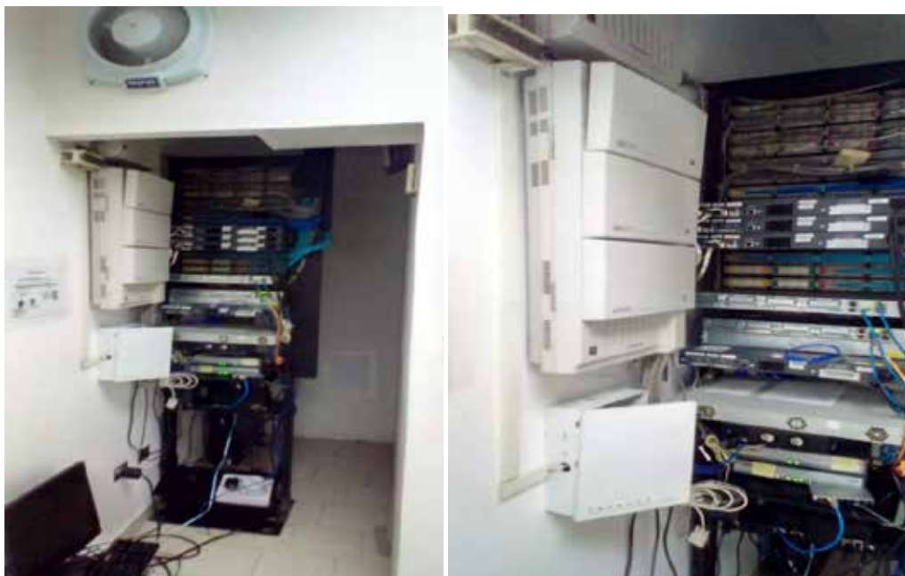
Figura N° 6: Cuarto de servidores de la empresa Rontarca Willis Towers Watson C.A, Sucursal Valencia
