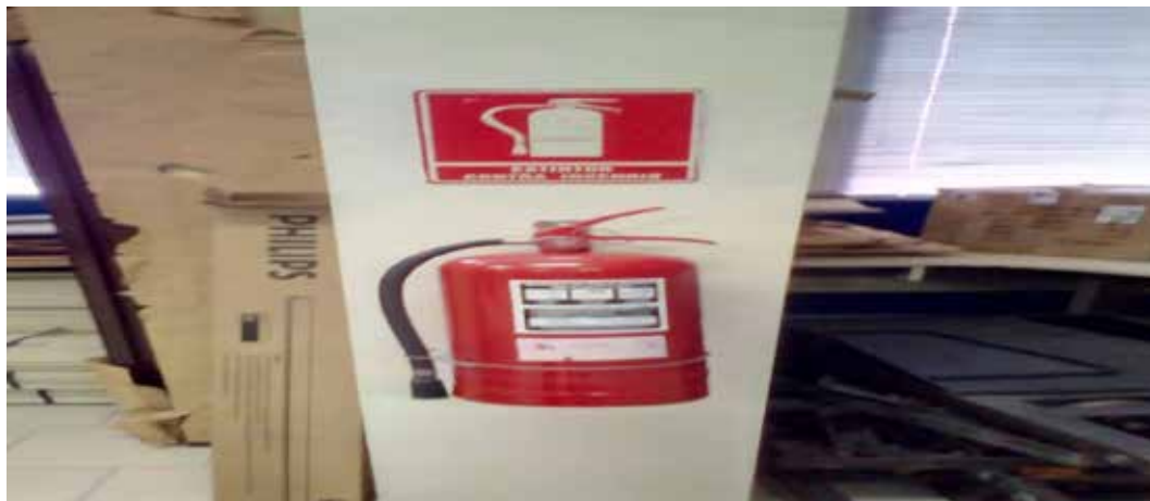
Figura N° 5: Extintor polvo químico pasillo principal de la empresa Rontarca Willis Towers Watson C.A, Sucursal Valencia
