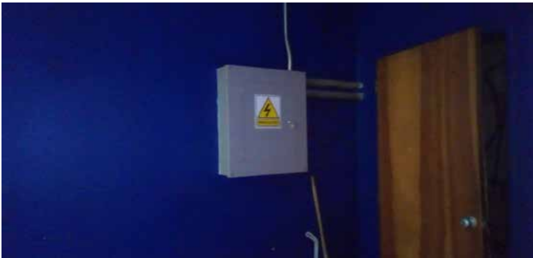
Figura N° 8: Cuarto de tuberías de la empresa Rontarca Willis Towers Watson C.A, Sucursal Valencia Fuente: Rontarca Willis Towers Watson C.A, Sucursal Valencia (2019)
