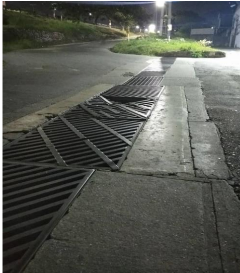
Figura 2: Mal estado de los sistemas de drenaje.
