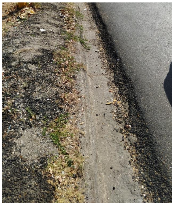
Figura 30: Falla desnivel calzada - hombrillo, presente en el tramo II.
