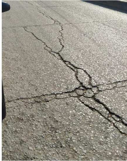
Figura 24: Falla grietas longitudinales y transversales, presente en el tramo I.
