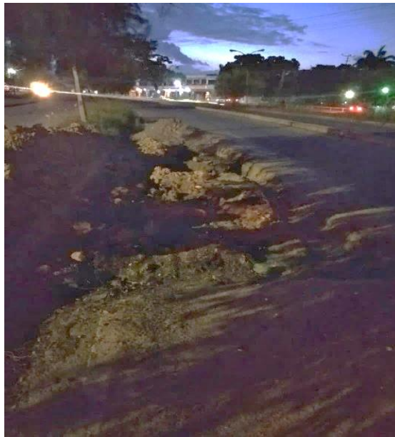
Figura 1: Deterioro de la capa de pavimento.
