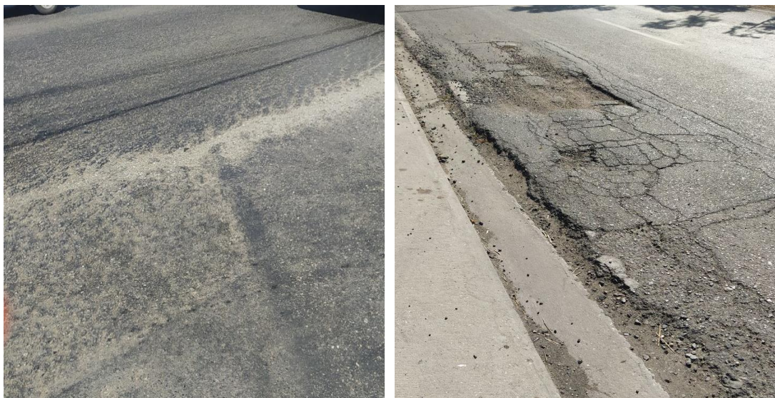
Disgregación, huecos y grietas presente en el tramo III.
