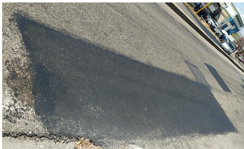
Figura 31: Falla baches y zanjas reparadas, presente en el tramo II.
