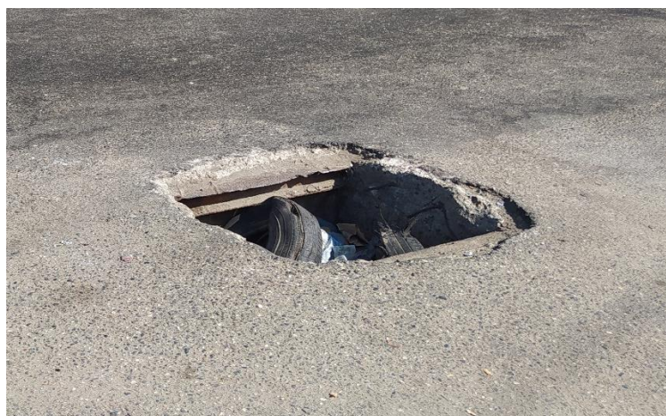
Figura 36: Falla huecos, presente en el tramo III.
