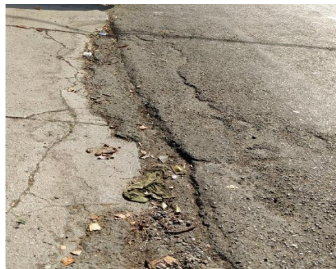
Figura 23: Falla grietas de borde, presente en el tramo I.
