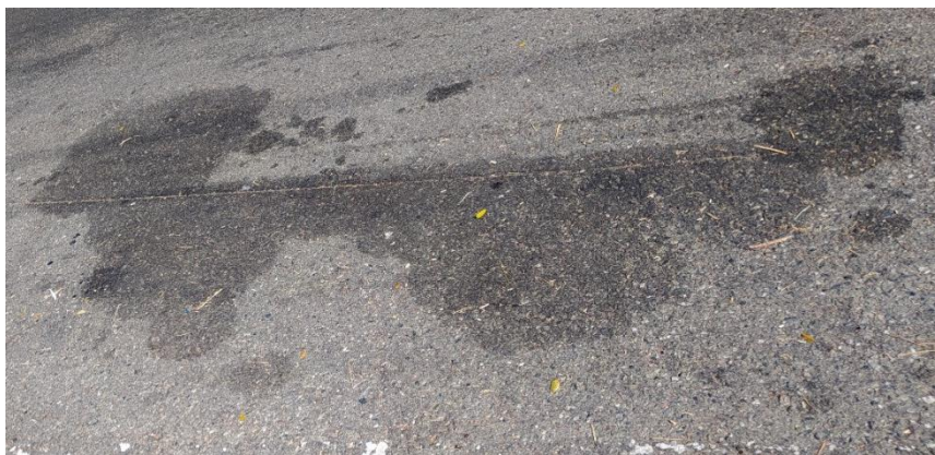
Figura 34: Falla manchas en pavimento (exudación), presente en el tramo III.
