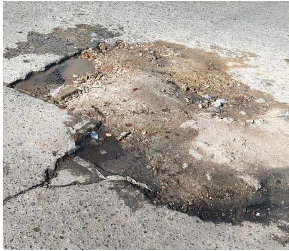
Figura 26: Falla huecos, presente en el tramo I.
