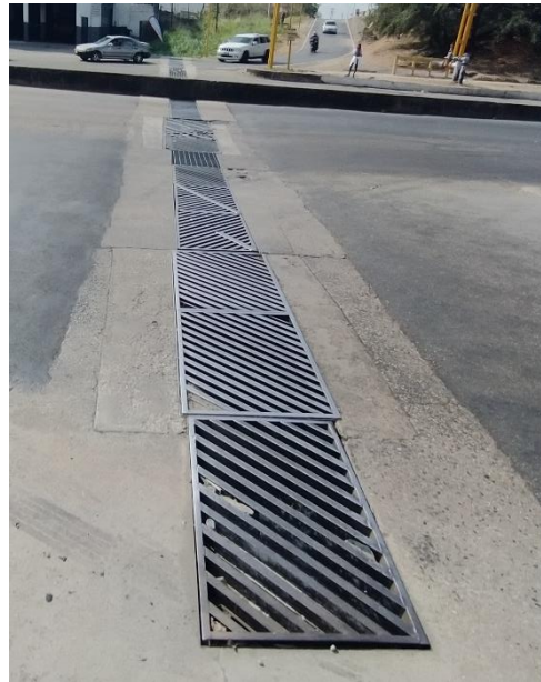
Figura 27: Falla desnivel por cruce de sumideros de rejillas, presente en el tramo I.
