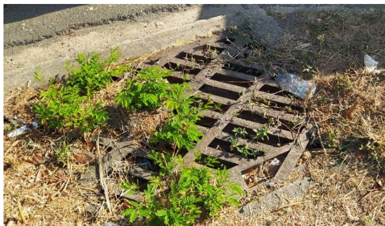
Figura 53: Sumidero de rejilla presente en el tramo III.
