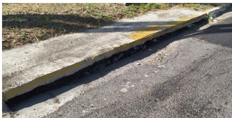
Figura 50: Sumidero lateral o de ventana presente en el tramo III.
