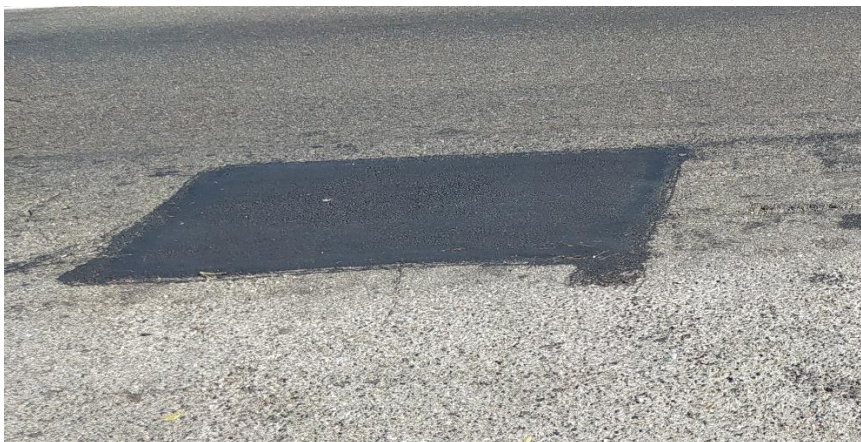
Figura 35: Falla baches y zanjas reparadas, presente en el tramo III.
