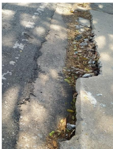
Figura 49: Sumidero lateral o de ventana presente en el tramo III.
