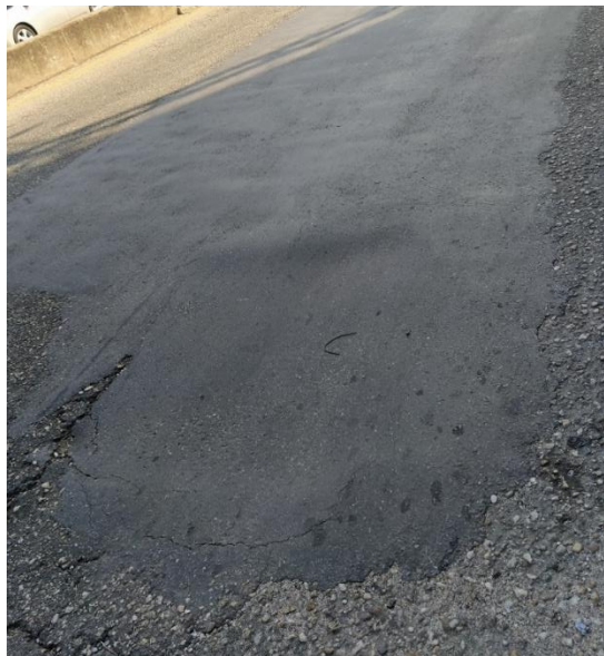
Figura 25: Falla baches y zanjas reparadas, presente en el tramo I.
