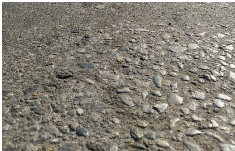
Figura 32: Falla disgregación y desintegración, presente en el tramo II.
