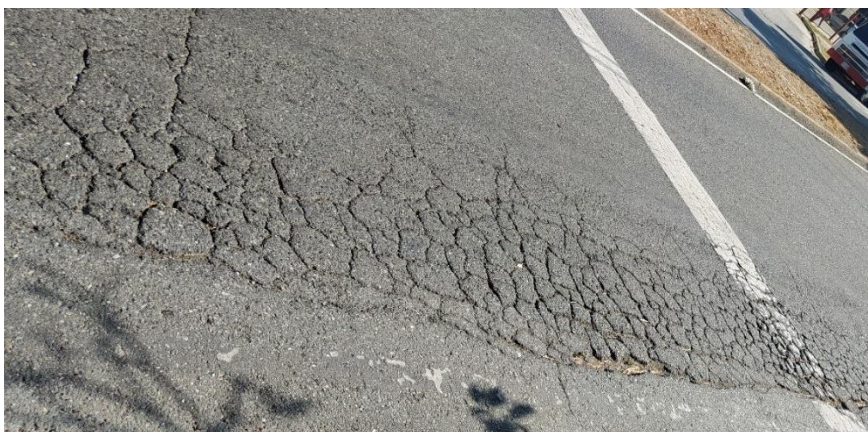
Figura 33: Falla piel de cocodrilo, presente en el tramo III.
