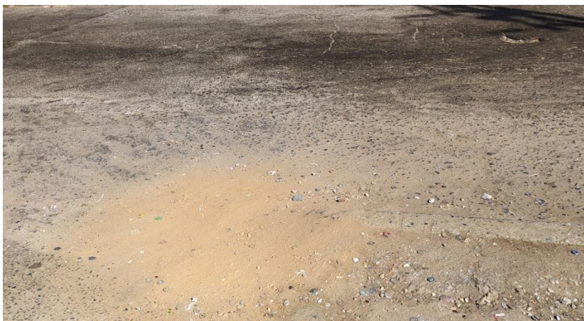
Figura 37: Falla disgregación y desintegración, presente en el tramo III.
