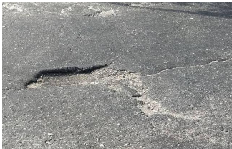
Figura 28: Falla elevaciones y/o hundimientos, presente en el tramo II.
