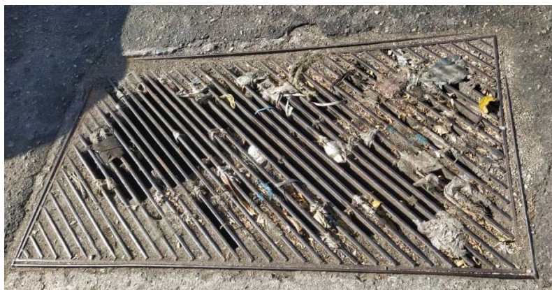
Figura 52: Sumidero de rejilla presente en el tramo III.
