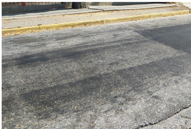
Figura 29: Falla manchas en pavimento (exudación), presente en el tramo II.
