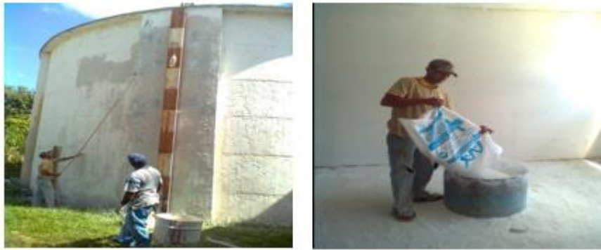
Figura Trabajadores sin equipos de seguridad
