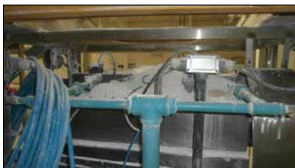
Figura 5: transportador cubierto de fosfato
