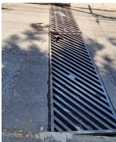
Figura 31: Deterioro del Sistema Hidráulico
