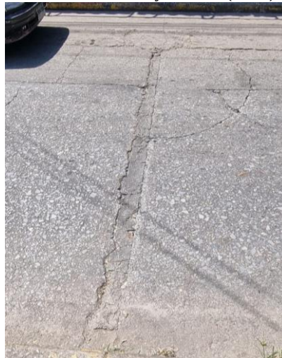
Figura 29: Grietas de Esquina
