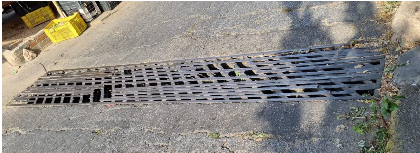
Figura 32: Deterioro del Sistema Hidráulico
