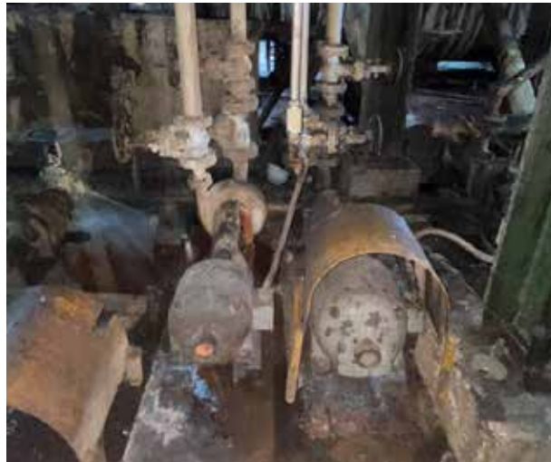
Figura 20. Bombas de agua caliente para los filtros rotativos Autor: Álvarez, S. (2021)
