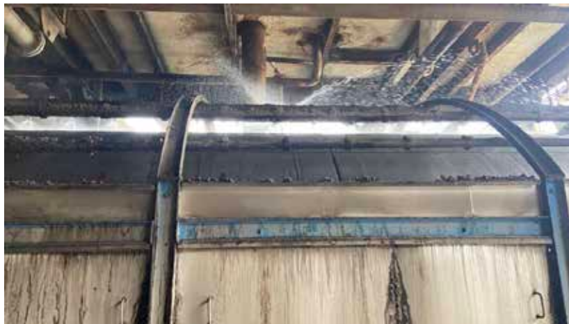
Figura 27. Aspersores ineficientes Autor: Álvarez, S. (2021)
