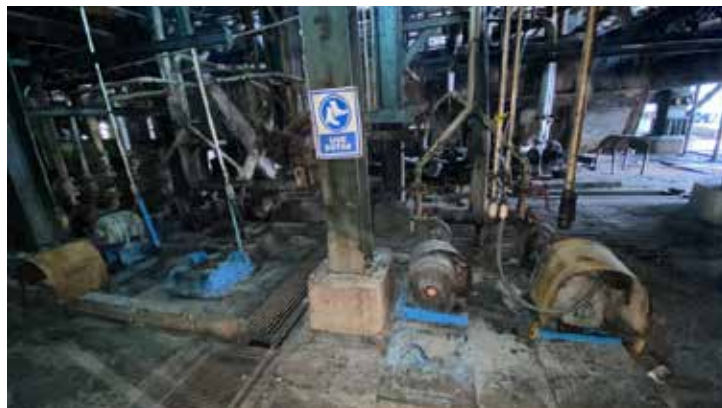
Figura 19. Bombas centrifugas de rebombeo de jugo turbio Autor: Álvarez, S. (2021)
