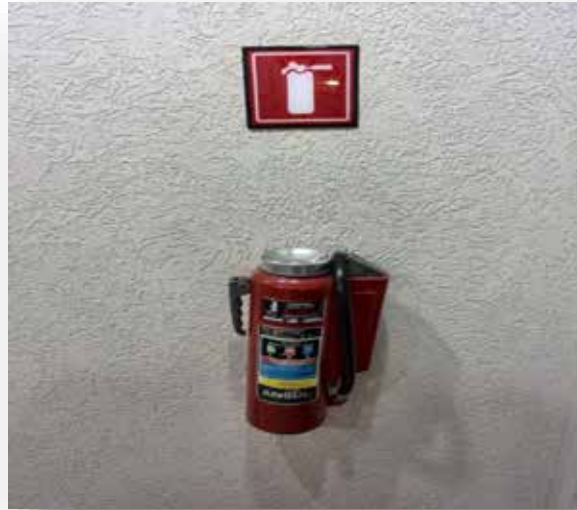
Figura 27. Extintor tipo PQS Fuente: Elaboración propia
