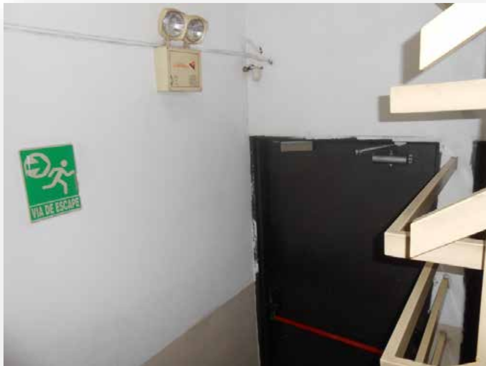
Figura 22. Puerta con cerradura electromagnética (superior izquierda) y barra antipánico (roja)
