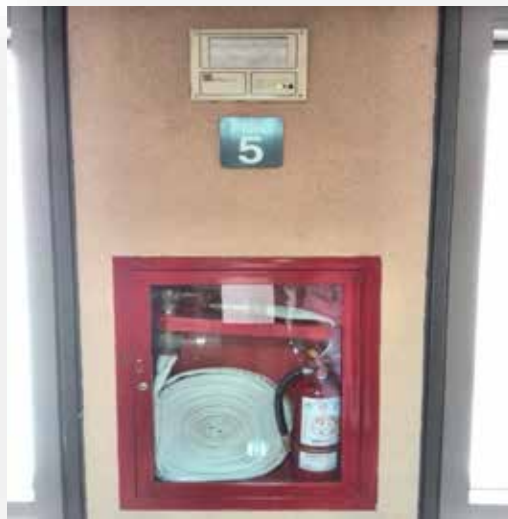
Figura 28. Gabinete para manguera contra incendio equipada Fuente: Elaboración propia
