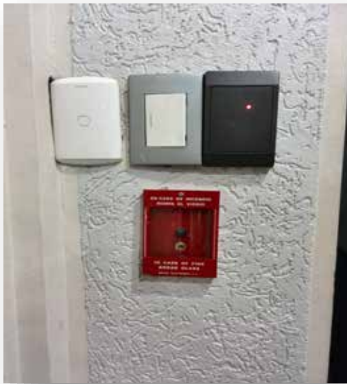
Figura 26. Estación manual contra incendio (rojo) Fuente: Elaboración propia
