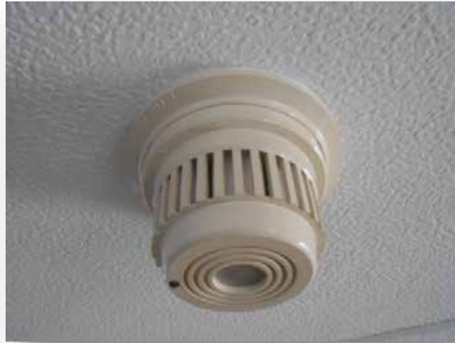
Figura 25. Detector de humo Fuente: Elaboración propia
