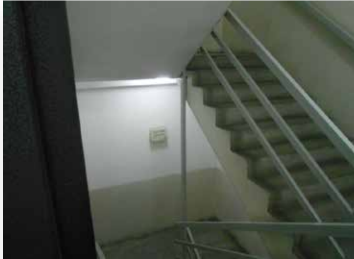
Figura 23. Lámpara de emergencia ubicada en el cruce de descenso Fuente: Elaboración propia
