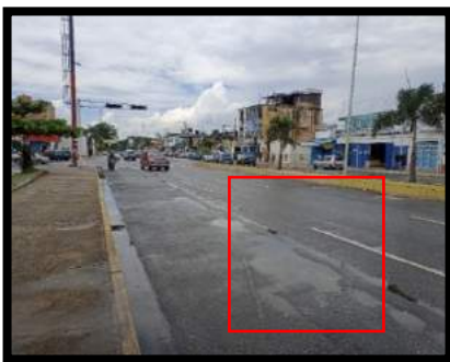
Imagen Nro.9. Condición del pavimento
