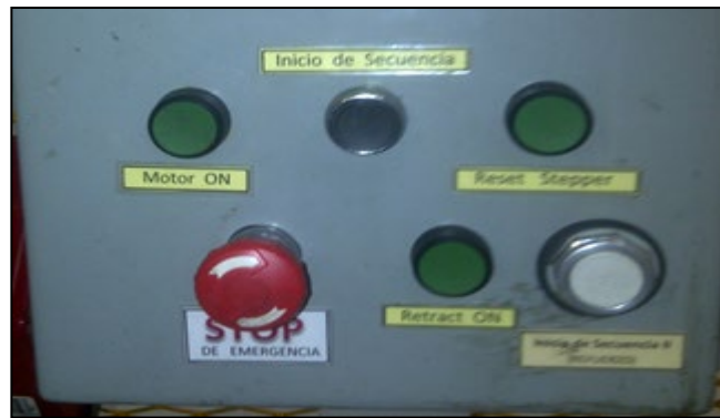
Figura 19. Tablero de control.
