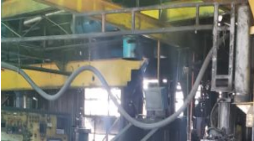
Figura 72: Grúa de traslación
