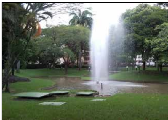
Figura 21. Bombas de la laguna. Fuente: Google Maps (2010)
