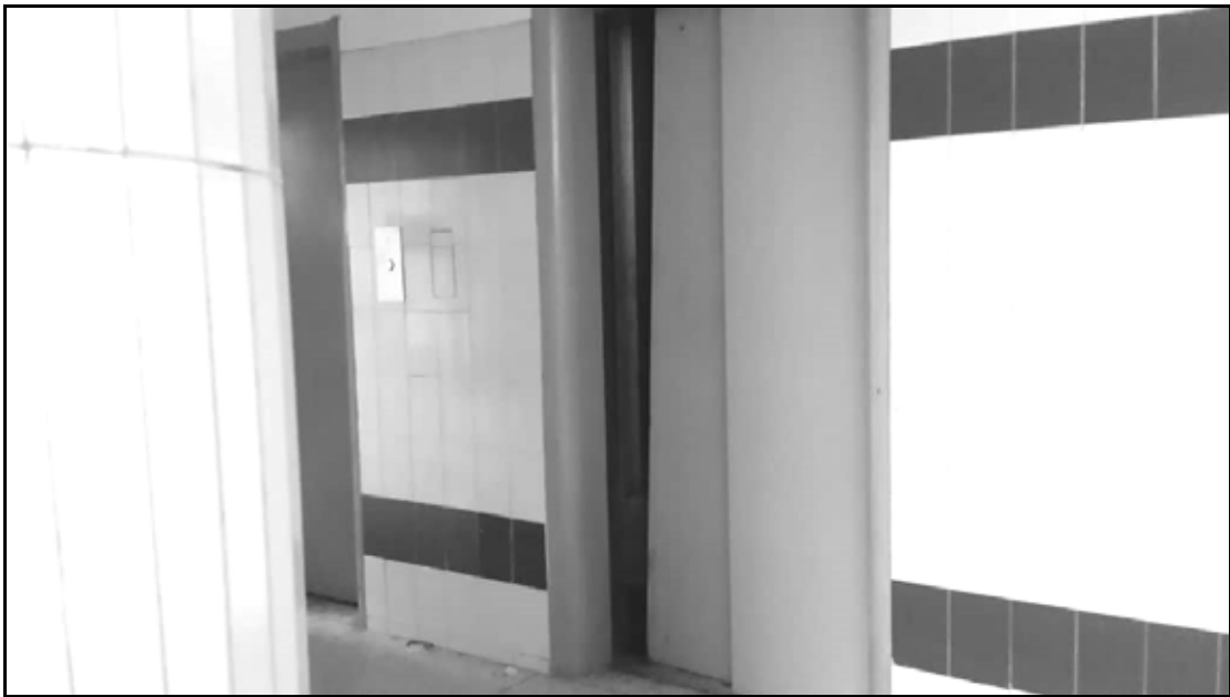
Ascensor de Medicina Interna Dañado
