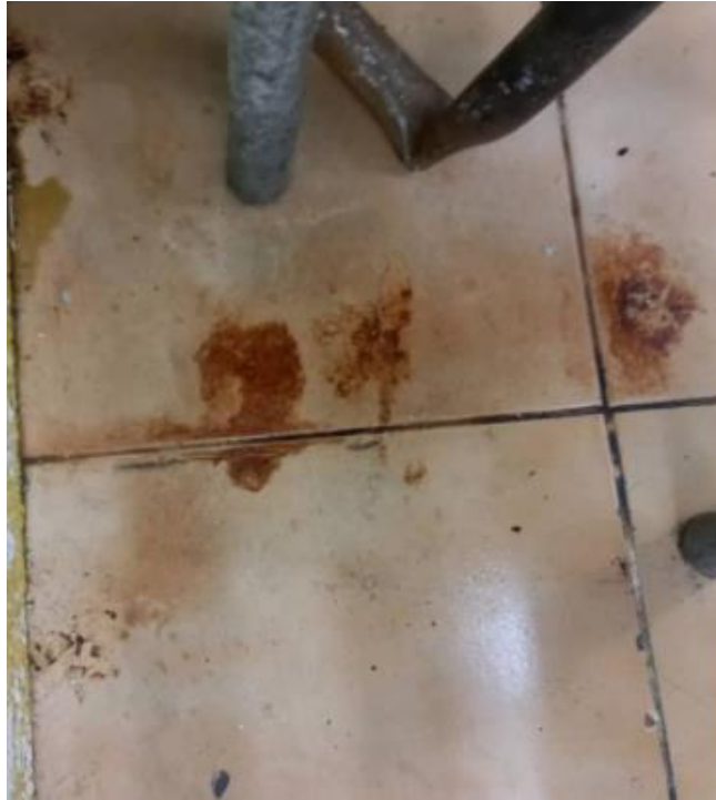
Figura 3: Suelo del Lab. de QA con oxidaciones debido al deterioro de los equipos del Laboratorio.
