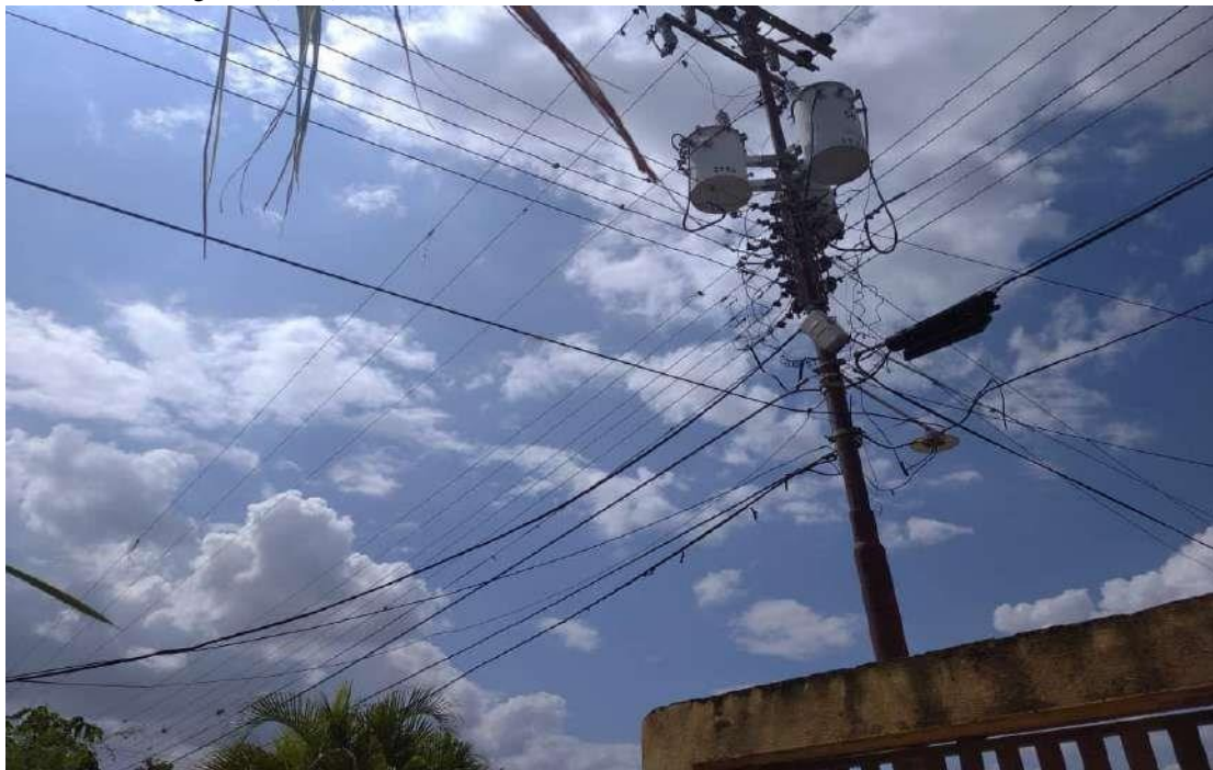
Figura 7: Canalización aérea de la línea de cobre de CANTV. Fuente: Balza, Figueroa (2021).
