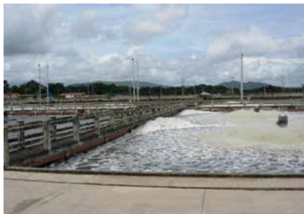
Figura 13. Planta de tratamiento la mariposa. Fuente: https://www.google.com/url (2020)
