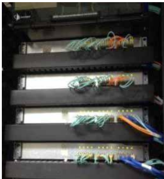
Figura 13. Switches principales conectados mediante fibra óptica.
