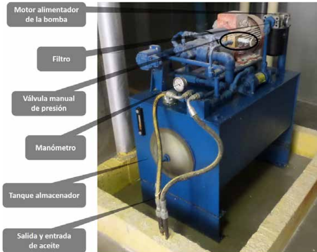
Figura 17. Unidad hidráulica del laminador.
