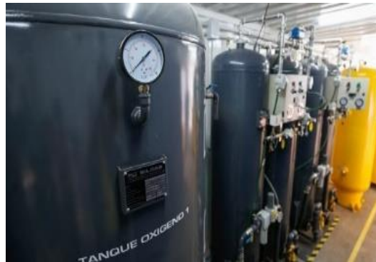
Figura 2. Revisión niveles de tanques estacionario de forma manual Fuentes: Saez, G (2022)
