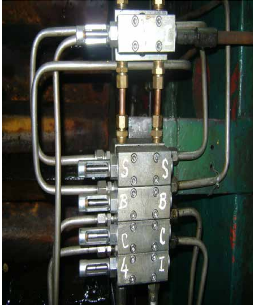
Figura 17. Sistema de dosificadores.
