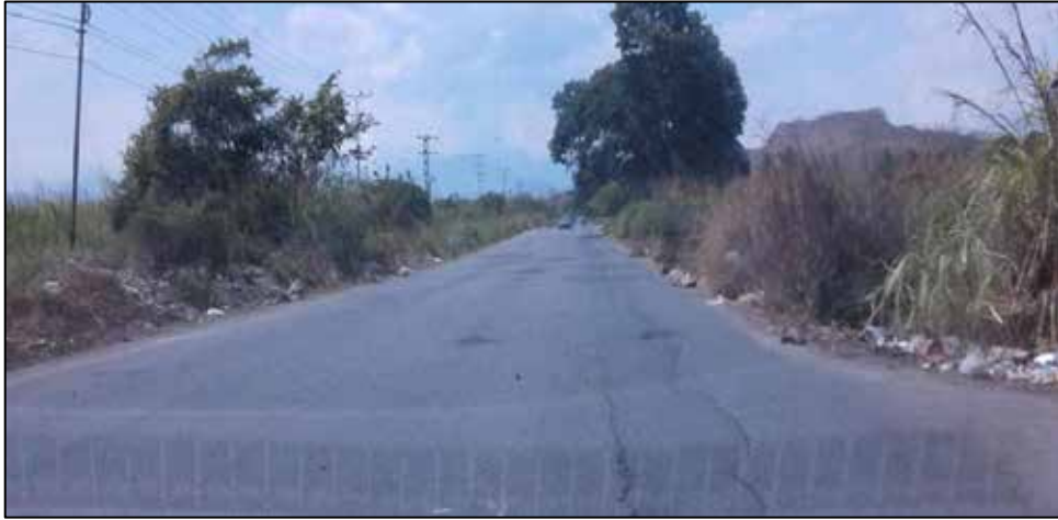
Figura 73. Grietas y Hundimiento. (Justo antes del puente)
