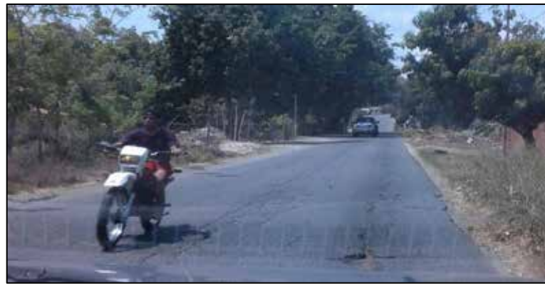
Figura 63. Grietas, Falla de borde y Baches Fuente: Francisco González (2019)
