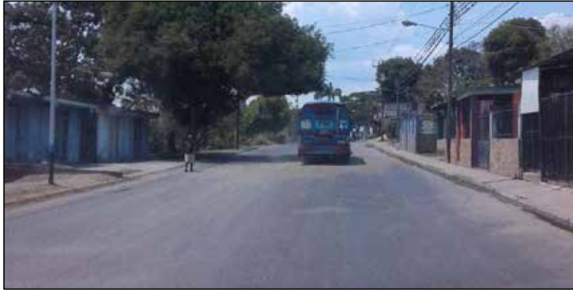
Figura 53. Grietas, Baches y Pérdida del pavimento
