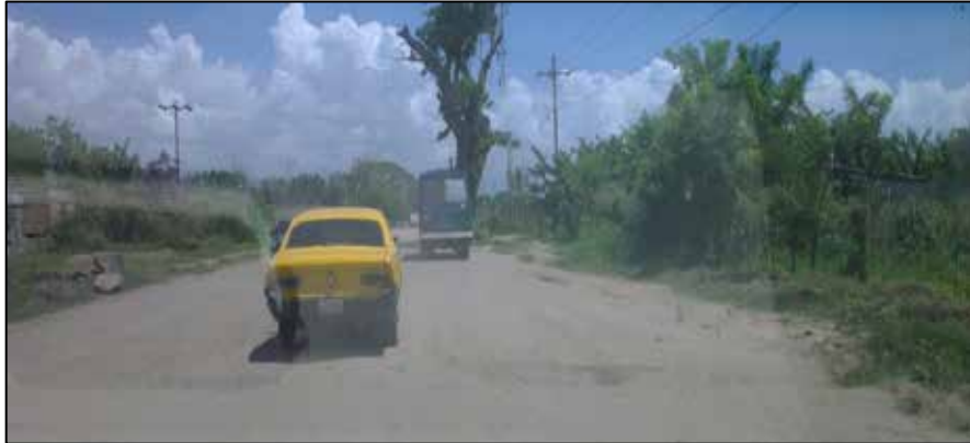
Figura 41. Pérdida parcial del pavimento y zanja Fuente: Francisco González (2019)
