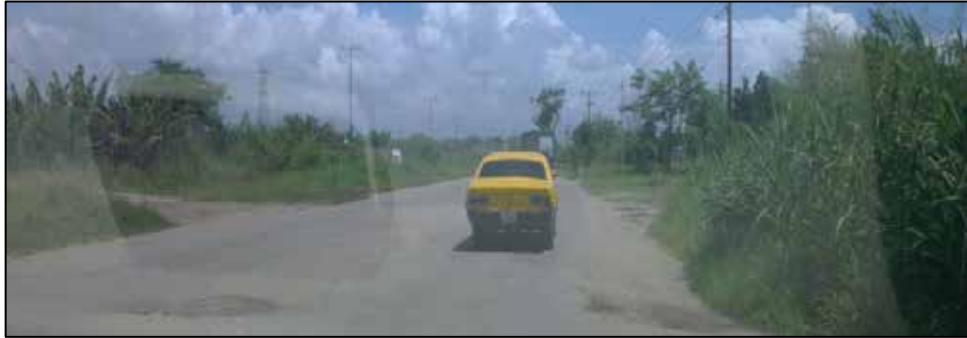
Figura 44. Baches, piel de cocodrilo y falla de borde.
