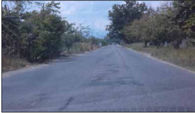
Figura 70. Grietas, Hundimiento, Bacheos y Baches Fuente: Francisco González (2019)
