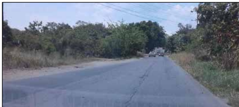
Figura 64. Grietas Fuente: Francisco González (2019)
