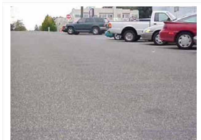
Figura 14. Nivel de severidad Bajo
