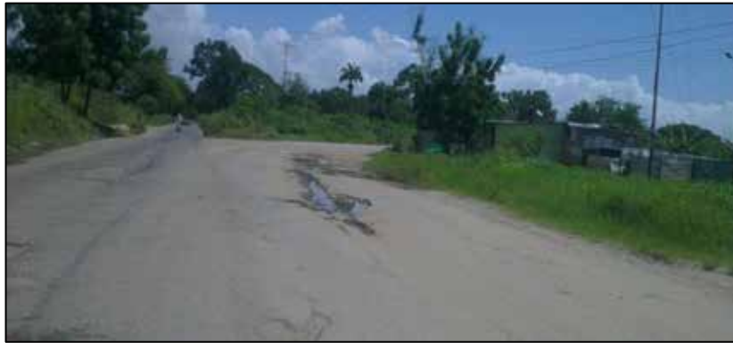
Figura 36. Descascaramiento y Grietas Fuente: Francisco González (2019)
