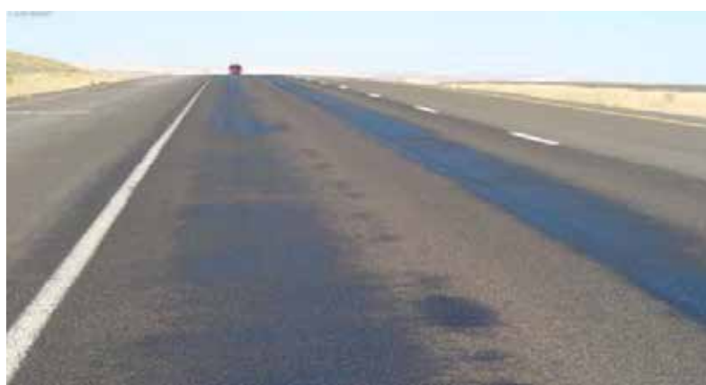
Figura 9. Mancha en Pavimentos (Exudación) Fuente: Ricardo Javier Miranda Rebolledo Valdivia – Chile 2010
