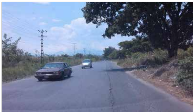
Figura 72. Grietas y Hundimiento Fuente: Francisco González (2019)
