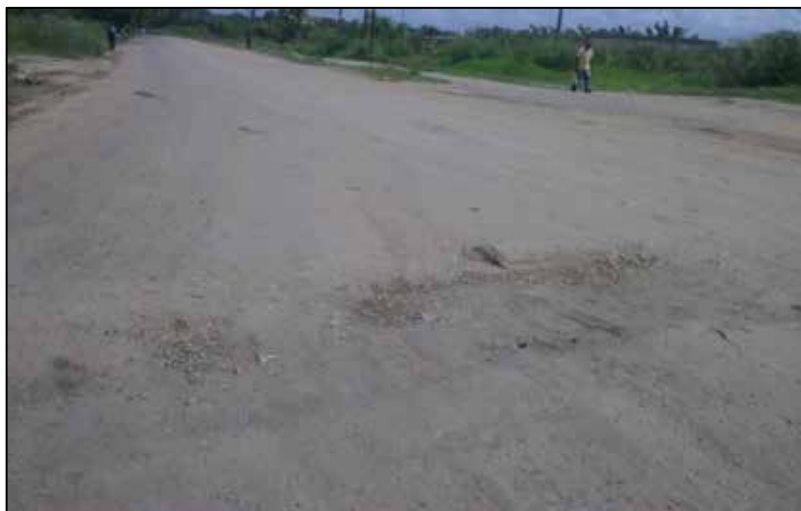
Figura 37. Zanja y Pérdida parcial del pavimento Fuente: Francisco González (2019)
