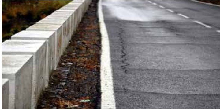
Figura 17. Grietas de Borde
