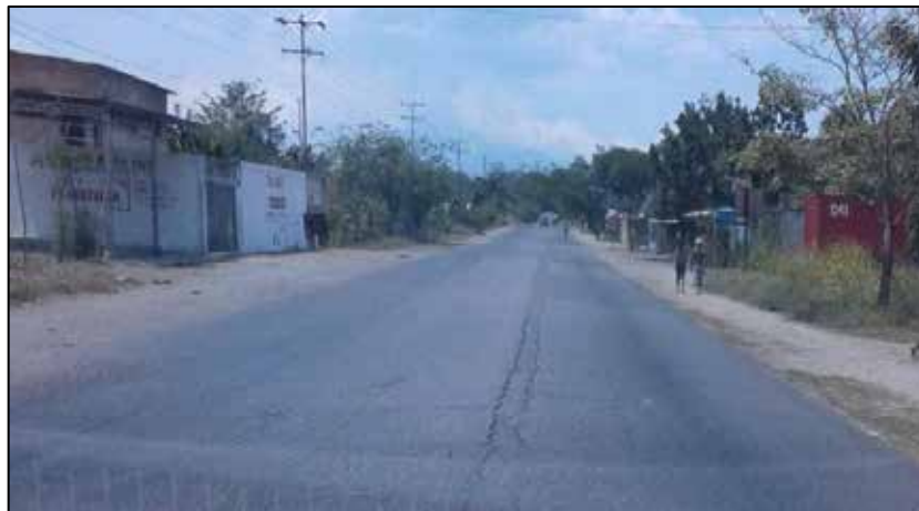
Figura 68. Grietas y Hundimiento Fuente: Francisco González (2019)
