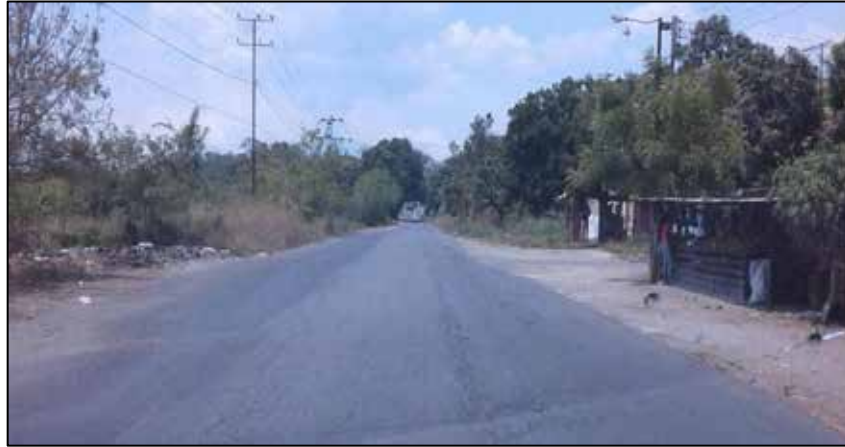
Figura 67. Grietas y Hundimiento Fuente: Francisco González (2019)
