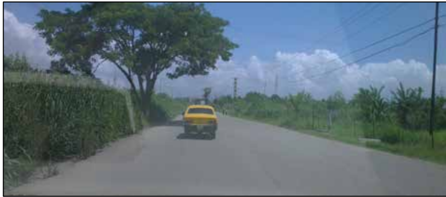
Figura 48. Desgaste superficial y Grieta Fuente: Francisco González (2019)
