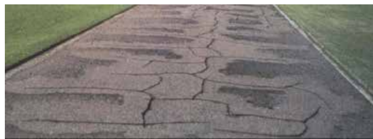
Figura 4. Grietas de Contracción o de Bloque Fuente: Ricardo Javier Miranda Rebolledo Valdivia – Chile 2010
