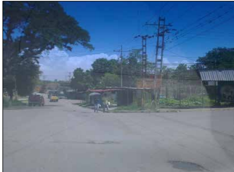
Figura 51. Grietas, Baches y Zanja Fuente: Francisco González (2019)
