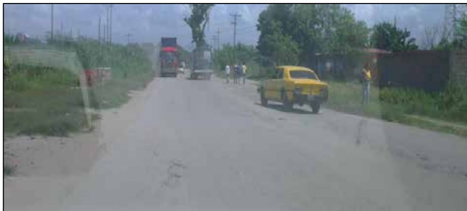
Figura 43. Baches y Grietas Fuente: Francisco González (2019)
