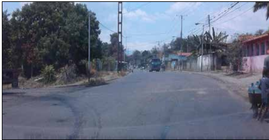
Figura 57. Grietas y Zanja
