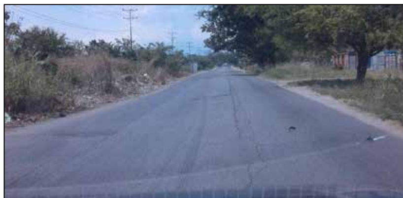
Figura 69. Grietas, Hundimiento y Bacheos Fuente: Francisco González (2019)
