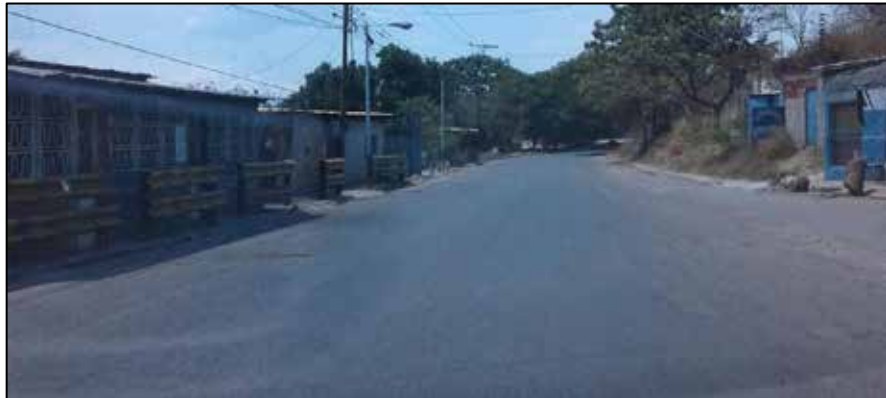
Figura 59. Baches y Desgaste Fuente: Francisco González (2019)
