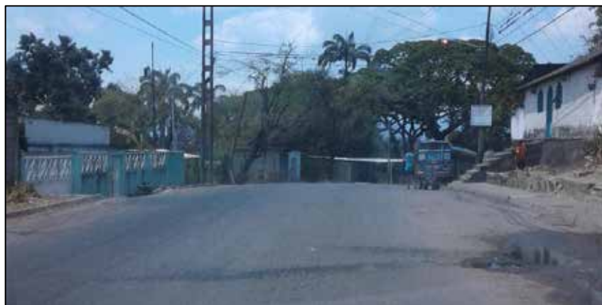
Figura 52. Grietas y Baches Fuente: Francisco González (2019)
