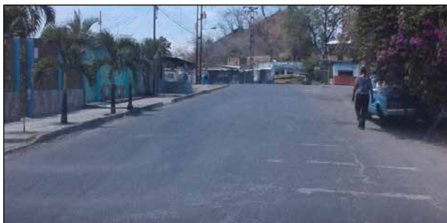
Figura 61. Grietas Fuente: Francisco González (2019)
