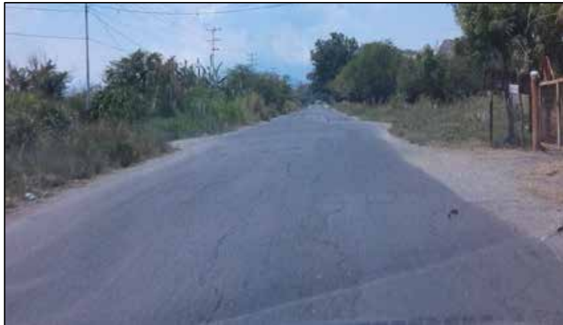
Figura 71. Grietas y Hundimiento Fuente: Francisco González (2019)
