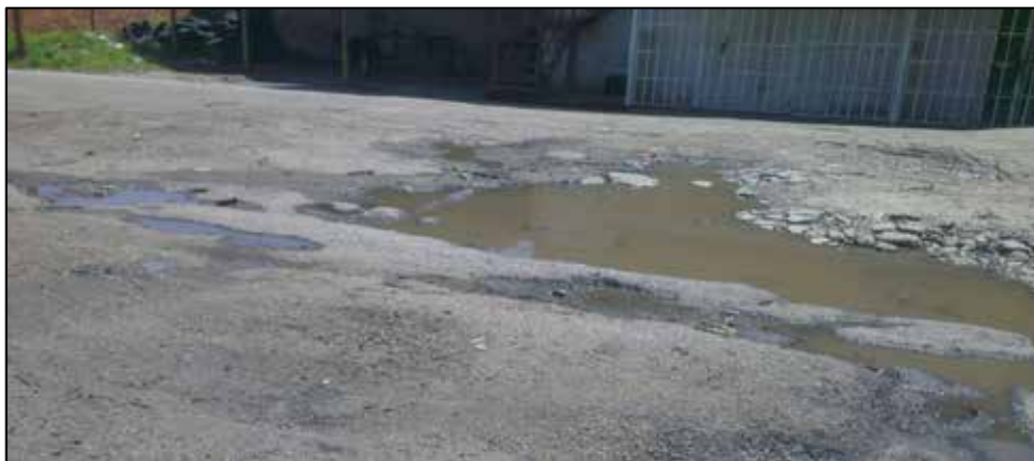
Figura 49. Bache de gran tamaño, Descascaramiento Fuente: Francisco González (2019)
