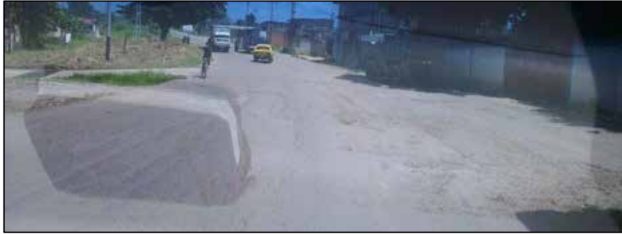
Figura 50. Grietas y Baches Fuente: Francisco González (2019)
