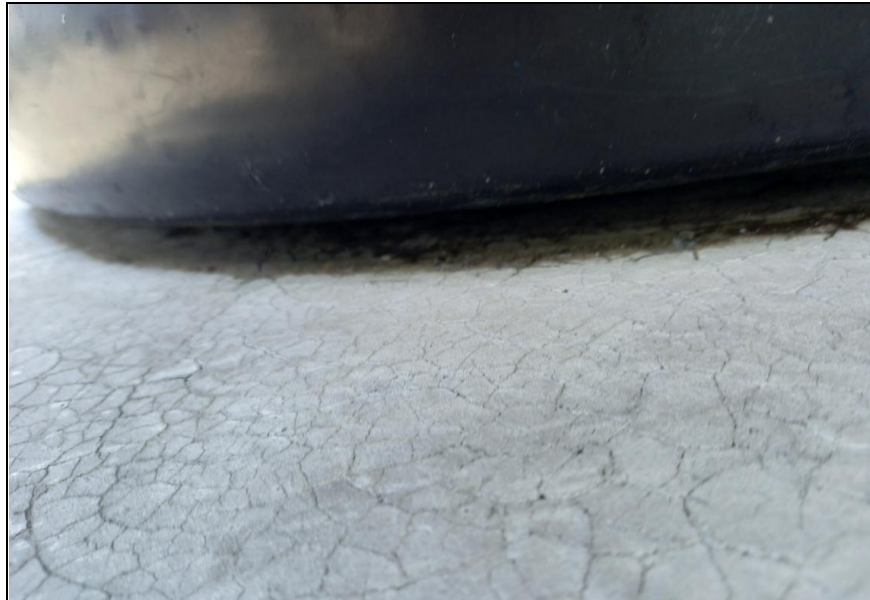
Figura 19: Filtración en el tanque elevado
