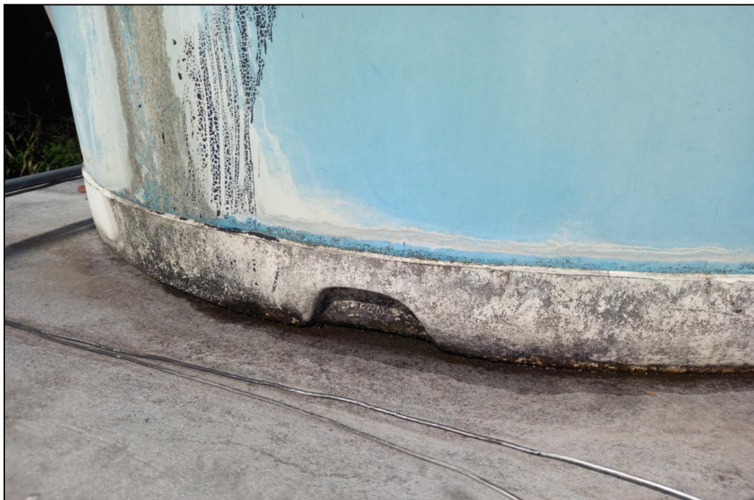
Figura 18: Filtración en el tanque elevado
