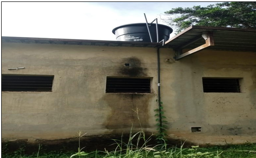
Figura 22: Abandono de obra del tanque elevado.
