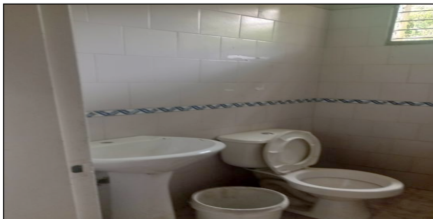
Figura 24: Abandono de los muebles sanitarios.
