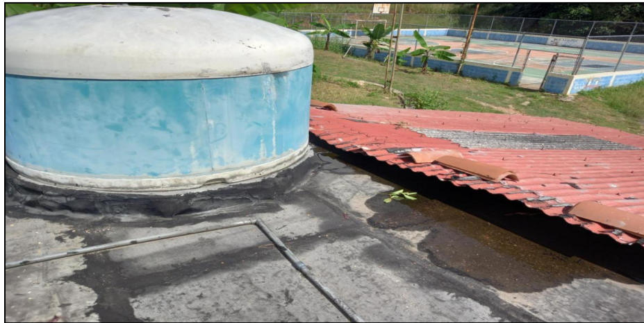
Figura 17: Filtración en el tanque elevado.
