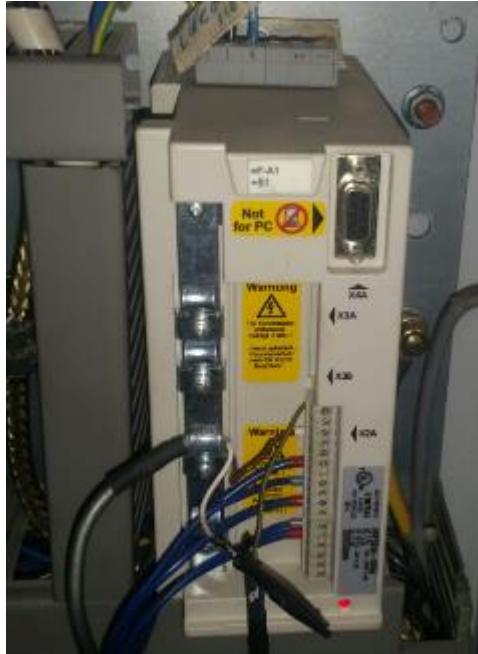
Figura 12. Variador de velocidad en el tablero
