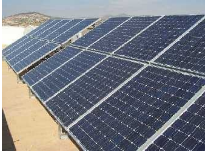
Figura 65. Detalle de Paneles Solares. Fuente: http://www.cemaer.org/como-funciona-un-panel-solar/
