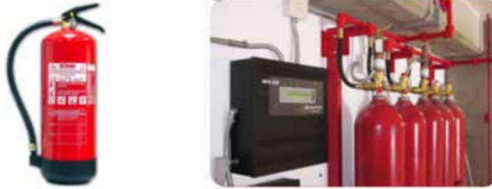
Figura 33. Equipos contra incendios. Google, (2020).
