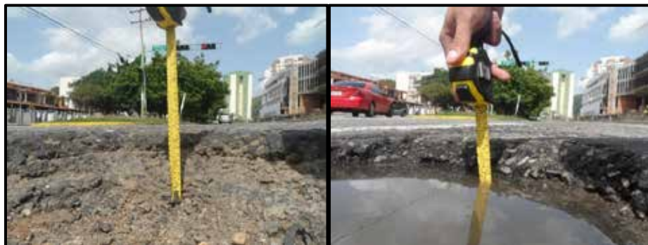
Figura 17. Daños en Capas Estructurales de la Av. Cuatricentenario
