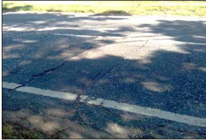
Figura 16. Deformaciones Av. Cuatricentenario
