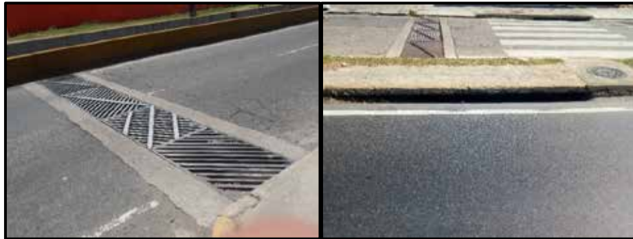
Figura 19. Sumideros de Reja Av. Cuatricentenaria
