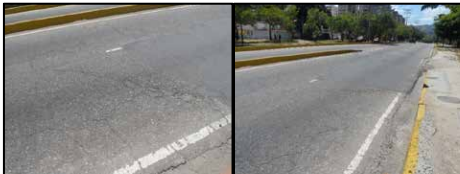
Figura 14. Fisuras Av. Cuatricentenaria Sentido Sureste / Noroeste
