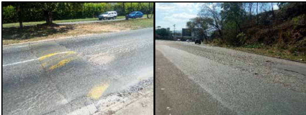
Figura 24. Daños en sistemas de seguridad vial
