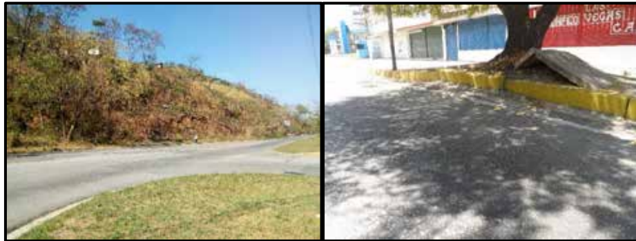
Figura 21. Taludes Irregulares Av. Cuatricentenaria
