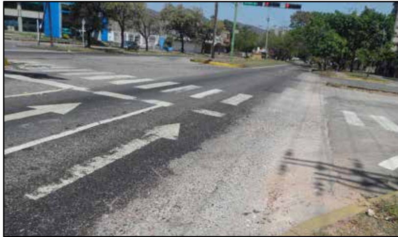
Figura 15. Daños Superficiales Av. Cuatricentaria
