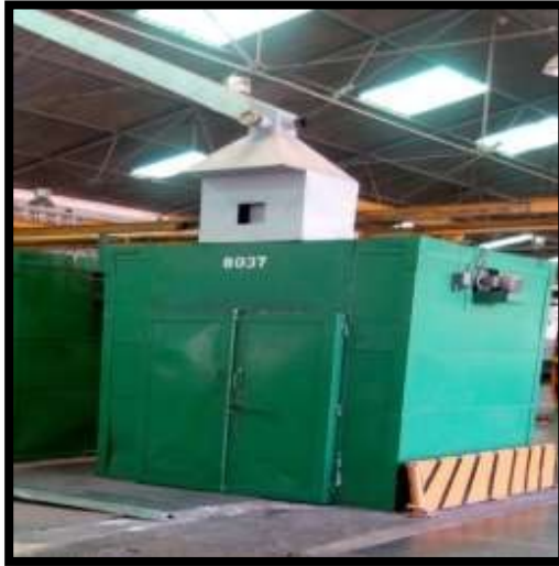
Figura 26. Horno para eliminar humedad.
