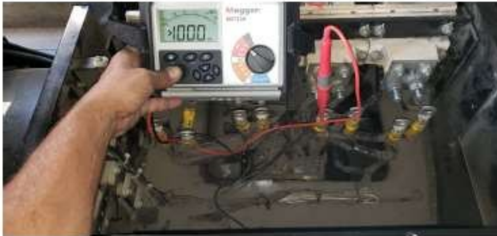
FOTO N° 8, PRUEBA DE AISLAMIENTO ENTRE T6/V2 - TIERRA (BOBINA 4)
