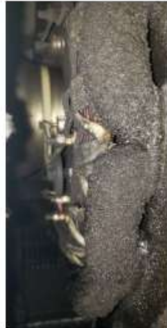
FOTO N°5, EXCESO DE POLVO
