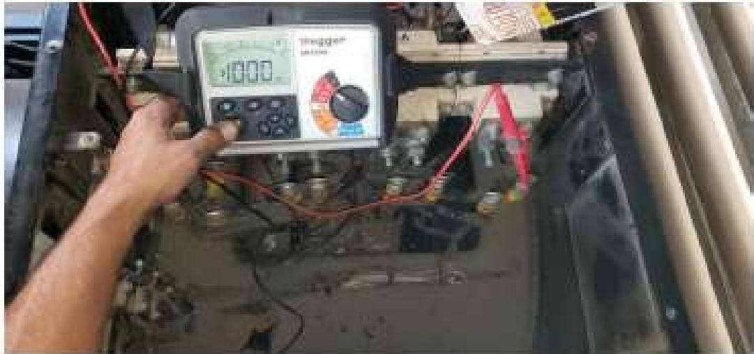
FOTO N° 8, PRUEBA DE AISLAMIENTO ENTRE T4/U2 - TIERRA (BOBINA 1)
