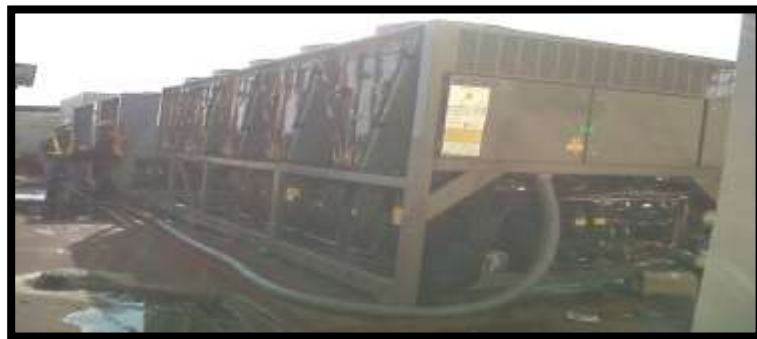
Figura 4: Chiller de Enfriamiento de aceite
