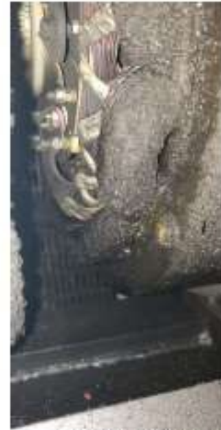
FOTO N°3, EXCESO DE ACEITE
