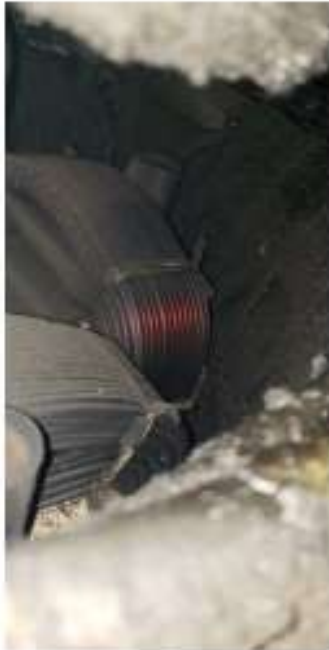
FOTO N°4, EXCESO DE HUMEDAD
