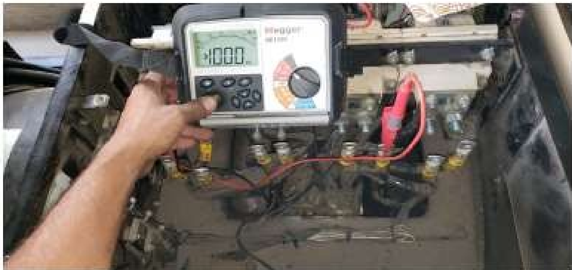
FOTO N° 7, PRUEBA DE AISLAMIENTO ENTRE T6/V2 - TIERRA (BOBINA 3)
