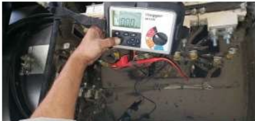
FOTO N° 7, PRUEBA DE AISLAMIENTO ENTRE T8/V6 - TIERRA (BOBINA 7)
