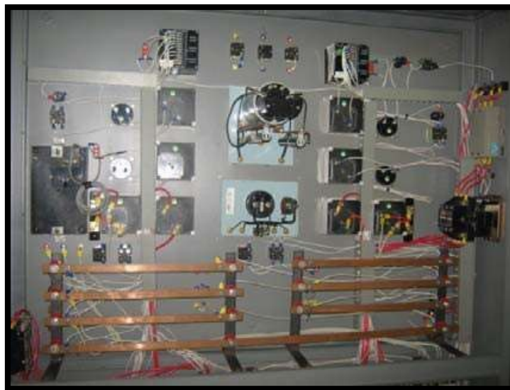
Figura 12. Ubicación y conexión de equipos (Parte trasera).
