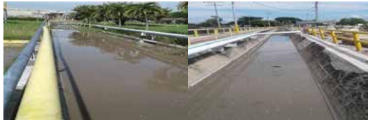
Figura 2. Canal de entrada a planta de tratamiento
