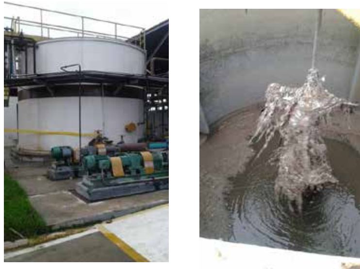
Figura 5. Tanque de Lodo
