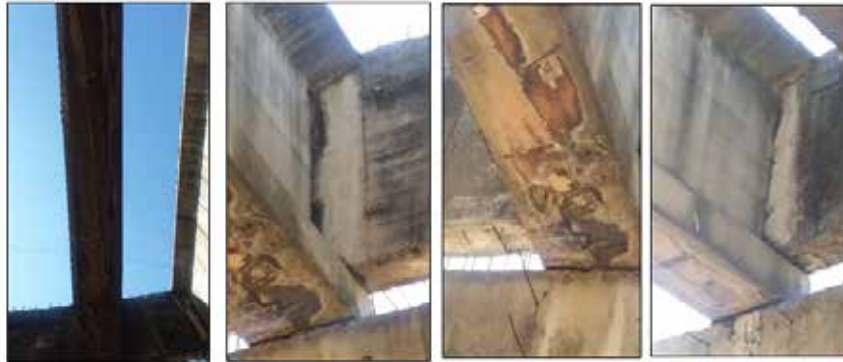
Figura 22. Estado actual de las vigas del puente olvidado
