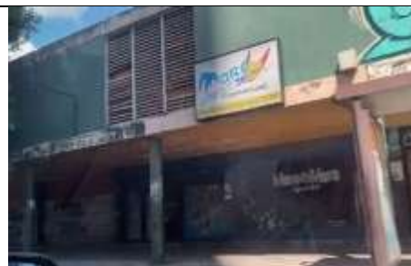
Figura 9. Condición edificios existentes Av. Bolívar. Fuente: La autora (2023)
