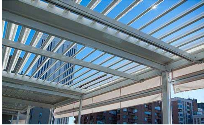
Figura 67 - Celosía de las de aluminio. Fuente: http://www.osibe.com/pergola/lamas/Celosia_de_Lamas_de_Aluminio_en_Color_Terraza_Atico.jpg . (2016)
