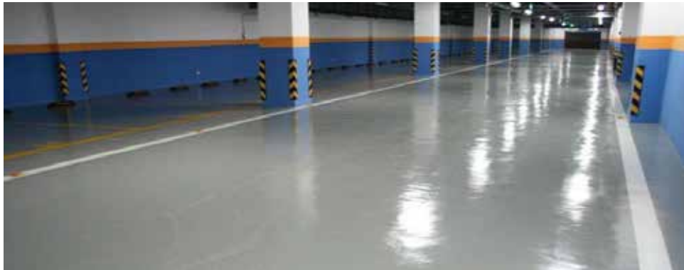
Figura 66 - Acabado de resina para pisos. Fuente: http://www.reischile.cl/imageslider2/5.jpg . (2016)
