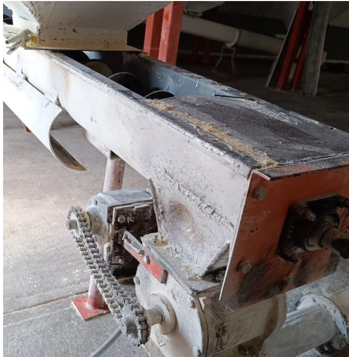
Figura 15. Motor y Sin fin transportador debajo del tanque de almacenamiento Fuente: Páez, J. (2024)
