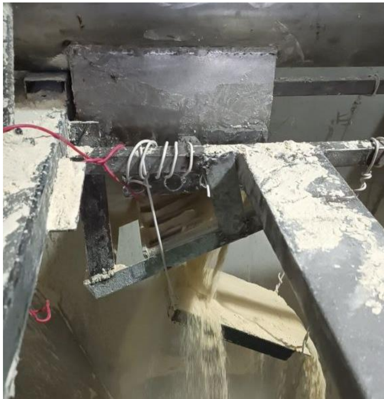
Figura 4. Vista interna del sistema manual de la Tolva 1 Fuente: Páez, J. (2024)
