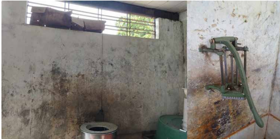
Figura 43. Paredes con falta de mantenimiento
