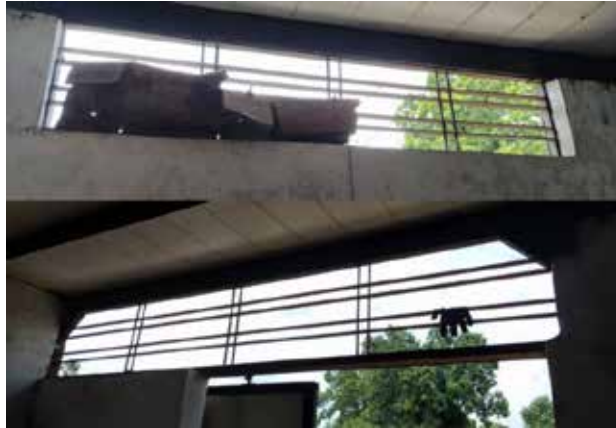
Figura 41. Ventanas sin protección anti-insectos
