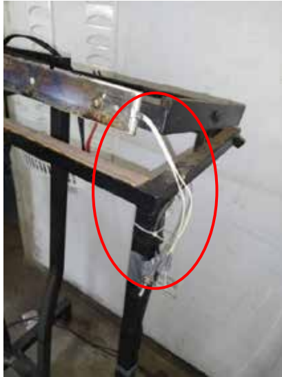
Figura 38. Condición insegura del dispositivo de sellado: cables eléctricos descubiertos
