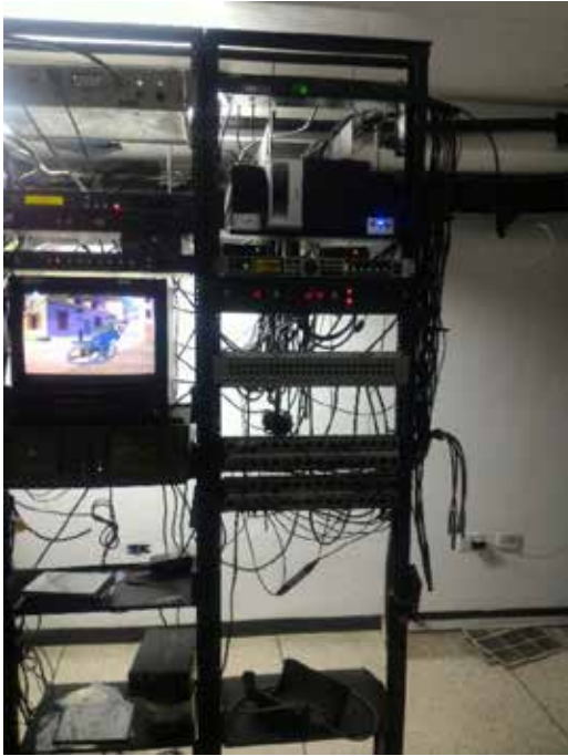
Figura 12. Racks 1 y 2 del Master Fuente: Contreras, C. (2018)
