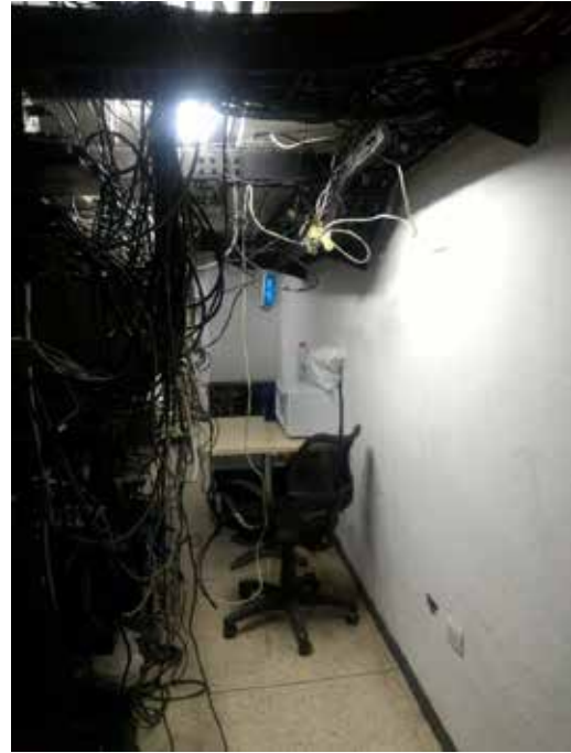
Figura 13. Cableado Actual Fuente: Contreras, C. (2018)
