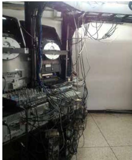
Figura 15. Cableado Actual Fuente: Contreras, C. (2018)
