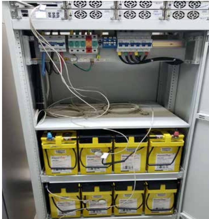
Figura 16. Banco de Baterías, CORE, Valencia. Edo Carabobo. Fuente: Campos, Jhoalbert (2020).
