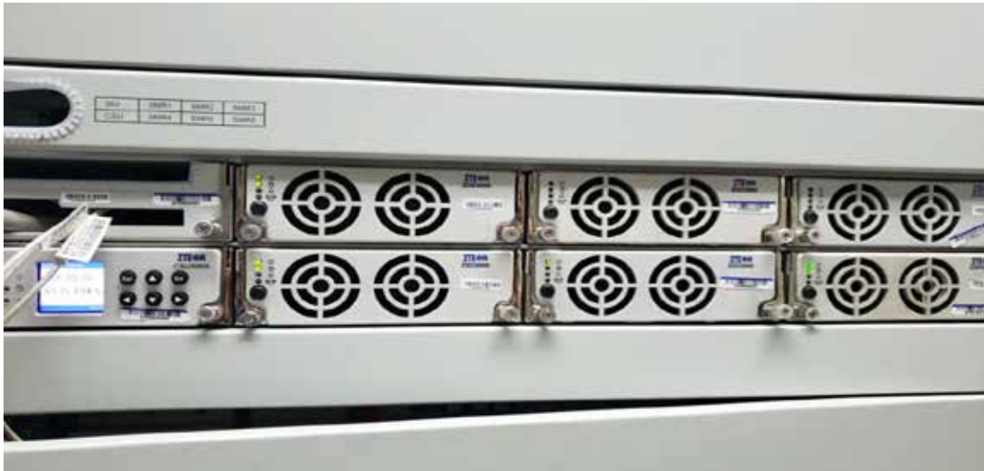
Figura 15. Rectificadores de Estación Base CORE Valencia, Edo. Carabobo Fuente: Campos, Jhoalbert (2020).
