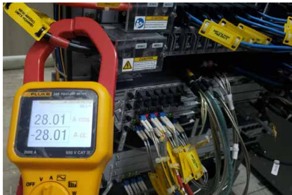
Figura 31. Medición de consumo de energía del Nodo 4G MTSO Telefónica Venezolana-Región Centro. Fuente: Campos, Jhoalbert (2020).
