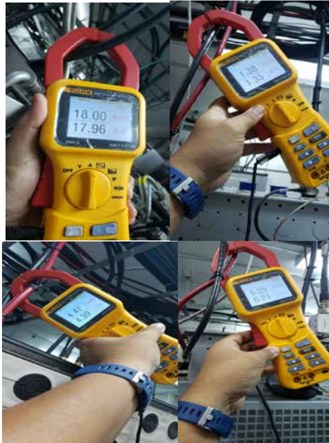
Figura 27. Mediciones de consumo de energía en el Nodo 2G en la Estación Radio Base, Mtso Telefónica Venezolana-Región Centro. Fuente: Campos, Jhoalbert (2020).
