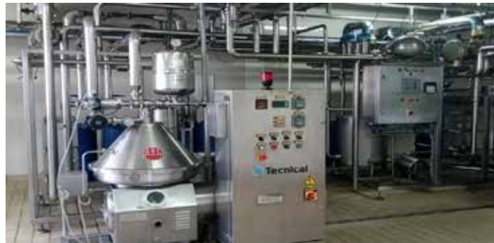
Figura 10: Área de Recepción de Leche Cruda
