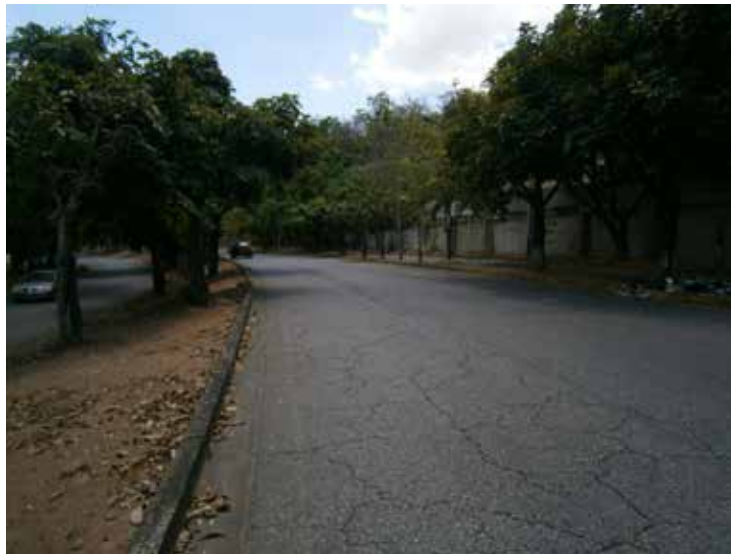
Figura 19. Estado de la calzada Fuente: Galíndez, Gómez (2019)
