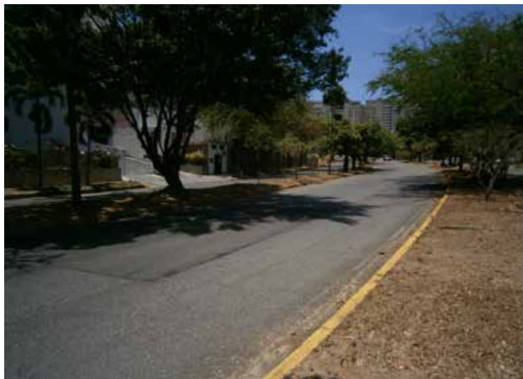
Figura 20. Estado de la calzada Fuente: Galíndez, Gómez (2019)
