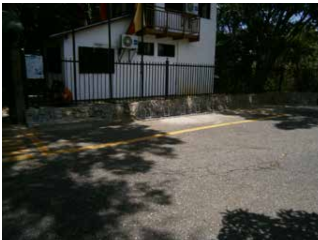
Figura 17. Estado de la calzada
