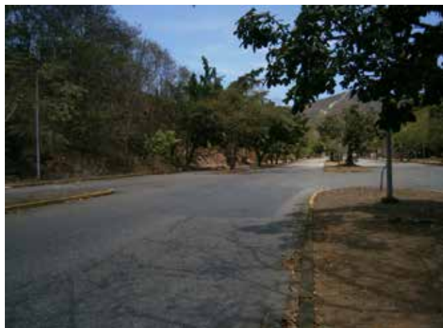
Figura 18. Estado de la calzada
