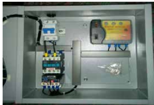
Imagen 22. Tablero de control analógico.
