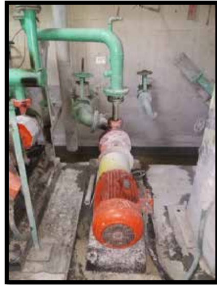
Figura 29 Bomba 802. Fuente: Bruguera F. (2020).
