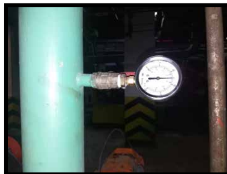
Figura 39 Indicador de salida de la bomba 1211.
