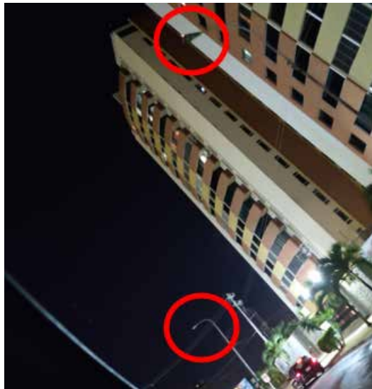
Figura 63: Poste N° 3,4 Luminaria no encendida Av. Norte-Sur 3. Fuente: Cuenca C. (2021).
