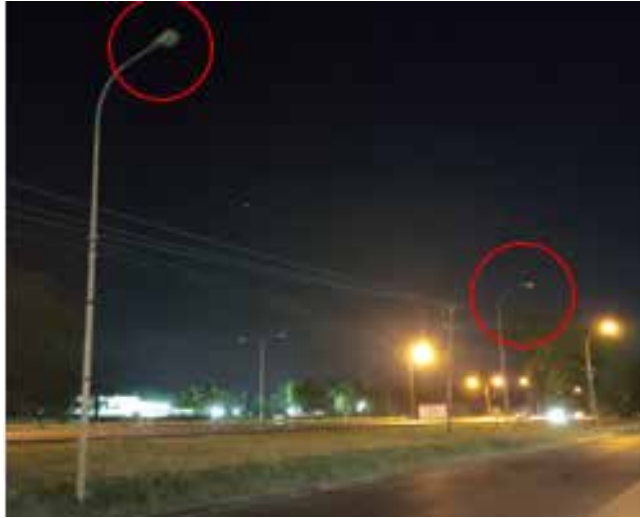
Figura 58: Poste N° 10,11 Luminaria no encendida vía de servicio. Fuente: Cuenca C. (2021).
