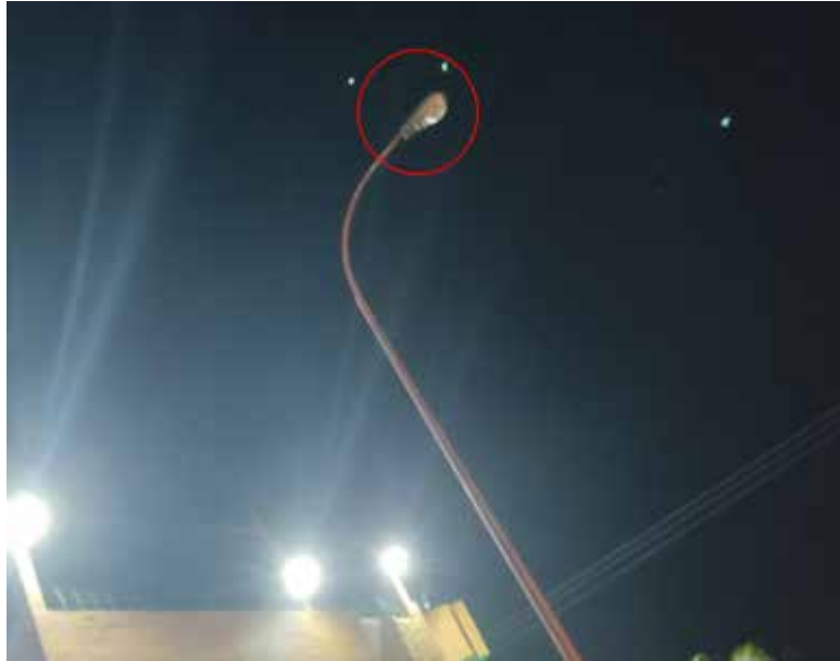
Figura 66: Poste N° 3 Luminaria no encendida en la Av. 3. Fuente: Cuenca C. (2021).
