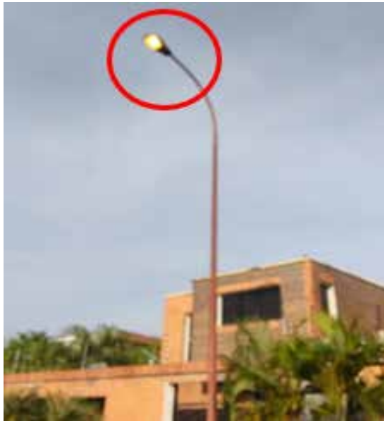
Figura 65: Poste N° 2 Luminaria Encendida en el día en la av.3 Fuente: Cuenca C. (2021).
