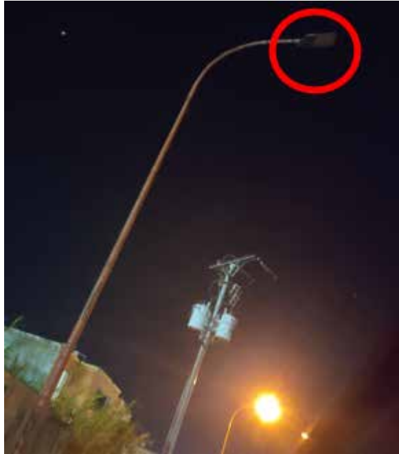
Figura 64: Poste N° 1 Luminaria no encendida en la Av. 3. Fuente: Cuenca C. (2021).
