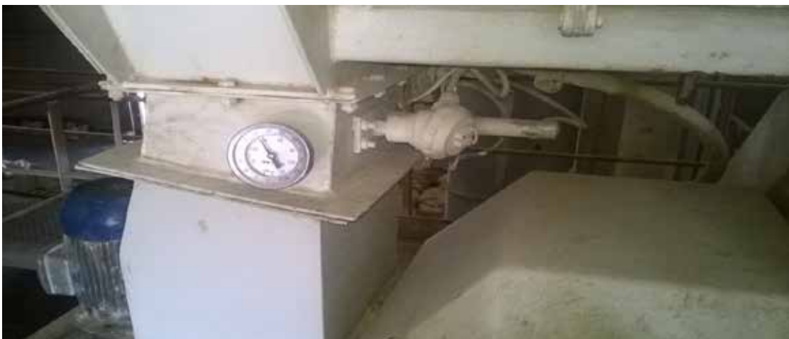
Figura.36. RTD Pt100 e indicador de temperatura de la maquina peletizadora de la empresa Alimentos lagunita Carabobo
