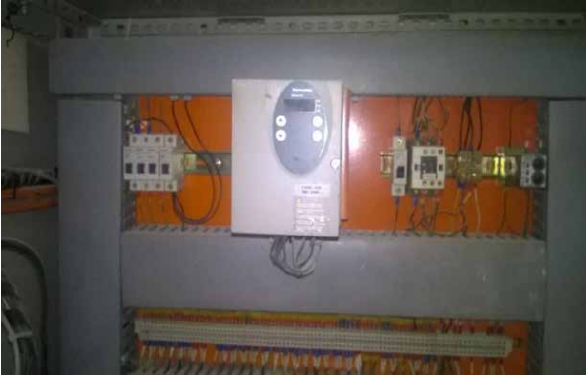
Figura.35. Variador de frecuencia del motor del alimentador de la maquina peletizadora de la empresa Alimentos lagunita Carabobo
