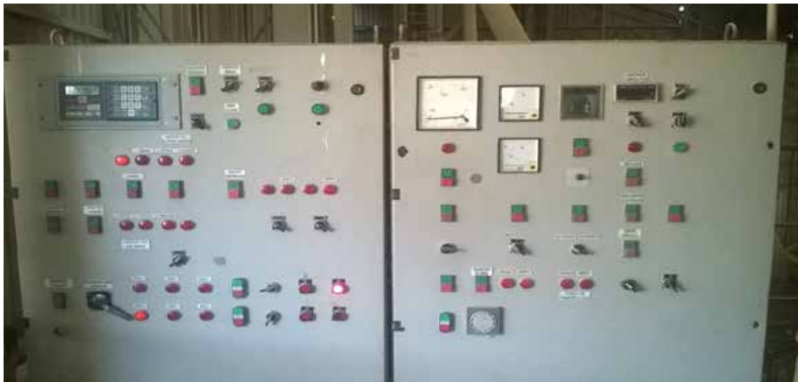
Figura.31. Tablero de control de la máquina peletizadora de la empresa Alimentos lagunita Carabobo
