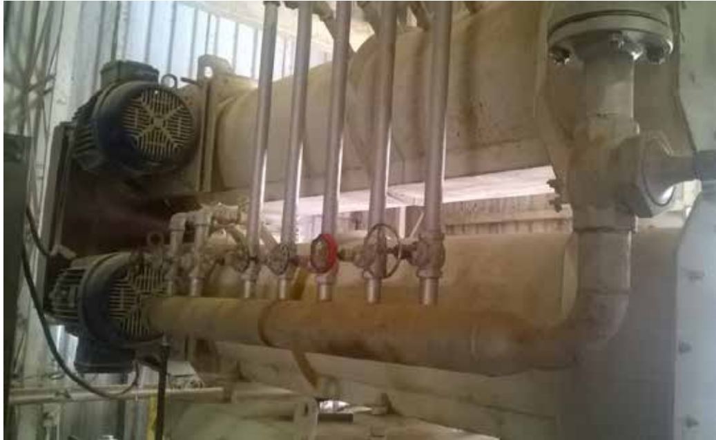
Figura.32. Motores de los acondicionadores y juego de válvulas de la maquina peletizadora de la empresa Alimentos lagunita Carabobo
