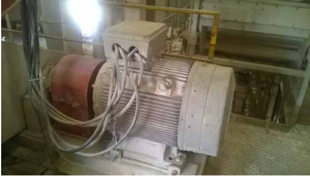
Figura.30. Motor de 150HP del molde de la peletizadora de la empresa Alimentos lagunita Carabobo
