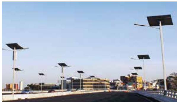
Figura N°43 Sistema de alumbrado público sustentable.
