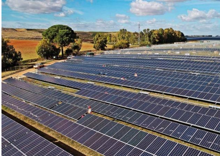
Gráfico 10: Paneles Solares Fotovoltaicos
