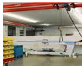
Grúa de dos vigas
