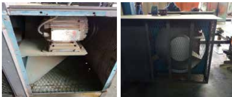
Figura 16: Ducto Expulsor de Aire Caliente. Fuente: Ostos D y Trujillo E (2020).
