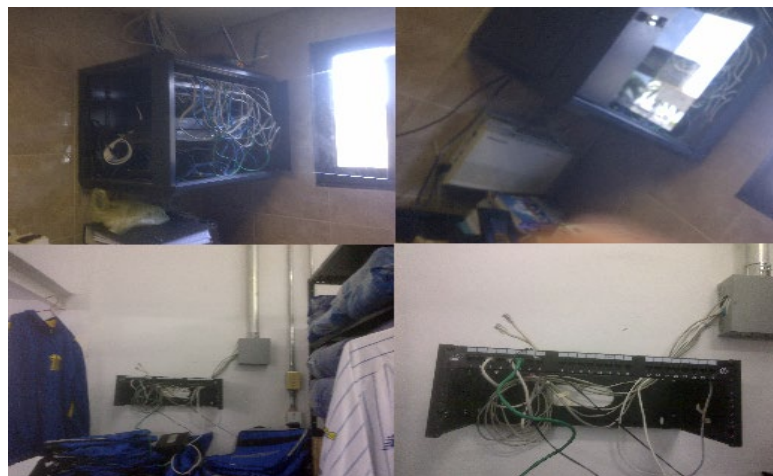
Figura N° 48: Rack primario y secundario.
