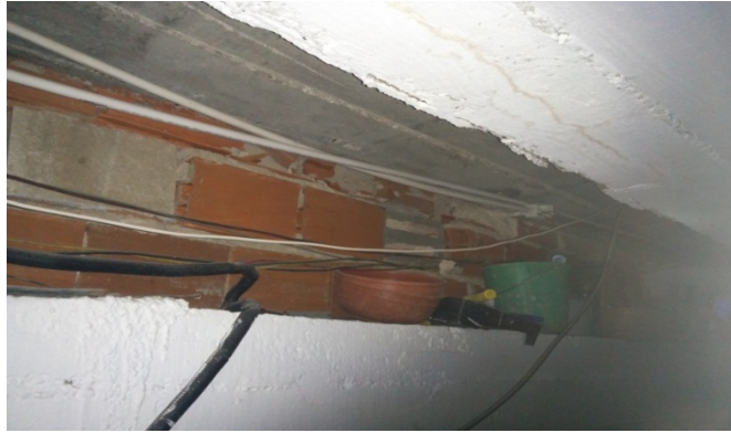
Figura N° 33: Estado del cableado que existía en el Club House del EJPB Fuente: El Autor
