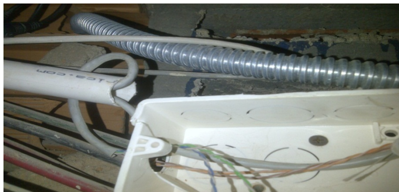
Figura N° 35: Cableado de cámaras del Club House del EJB Fuente: El Autor
