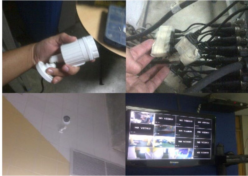
Figura N° 51: Sistema CCTV Fuente: El autor.
