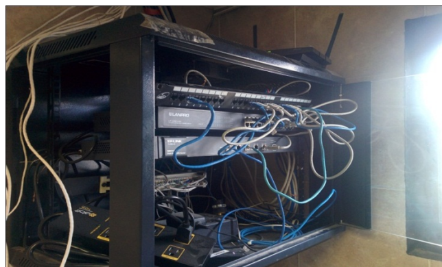
Figura N° 34: Rack del Club House del EJPB Fuente: El Autor
