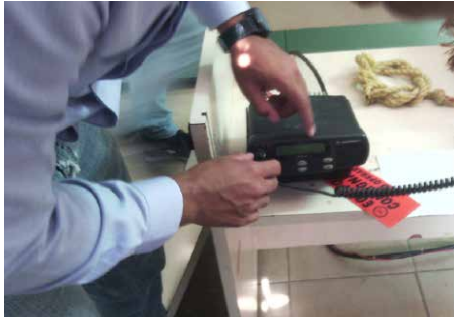
Figura 42: Prueba realizada en la Subestación Santa Clara Fuente: Lugo 2020
