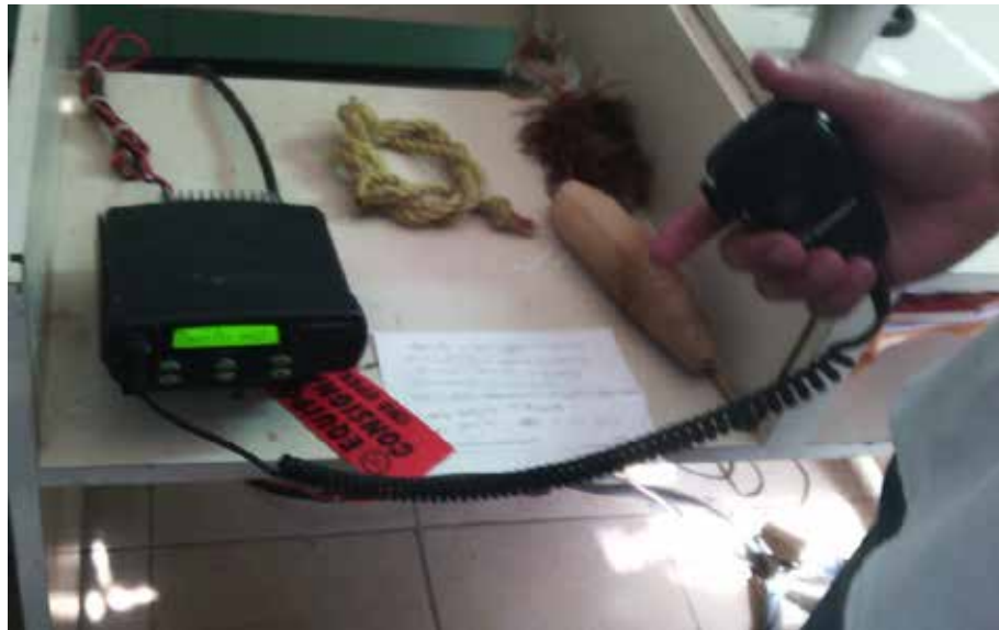
Figura 43: Prueba realizada en la Subestación Santa Clara Fuente: Lugo 2020
