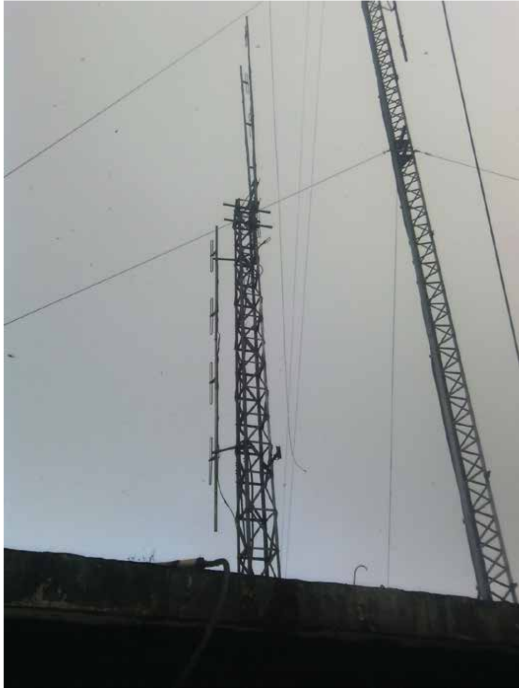
Figura 40: Antena Db 224-E instalada en Cerro Platillón Fuente: Lugo 2020
