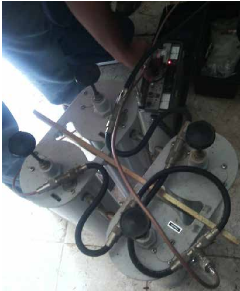
Figura 36: Calibración del Duplexer Fuente: Lugo (2020)
