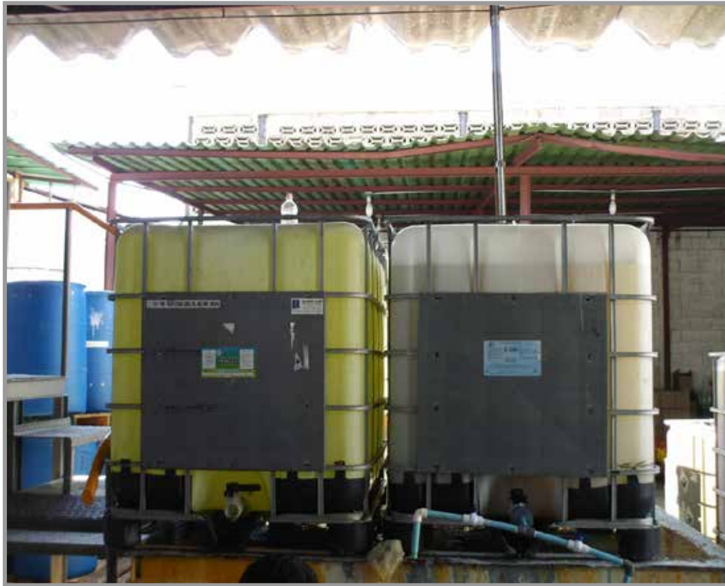
Figura 5 Contenedores de 1000 litros de Producto Terminado
