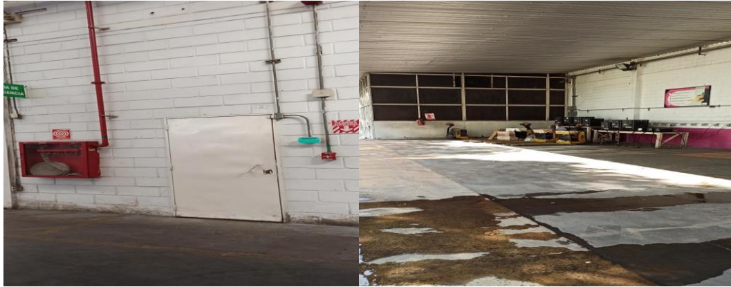
Figura 6: Áreas sin Señalización Adecuada.
