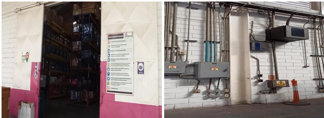
Figura 2: Situación Observada en el Sistema de Iluminación y Eléctrico Fuente: Gerente de Servicios Integrales Sillaca
